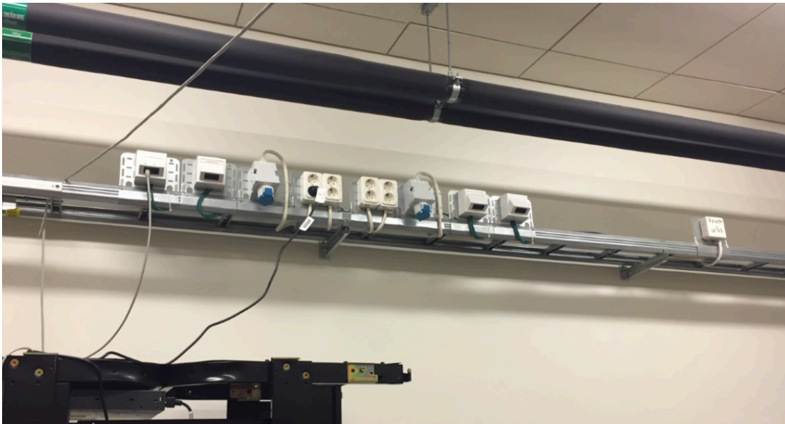
Figura 32 – Caminho de cabos
