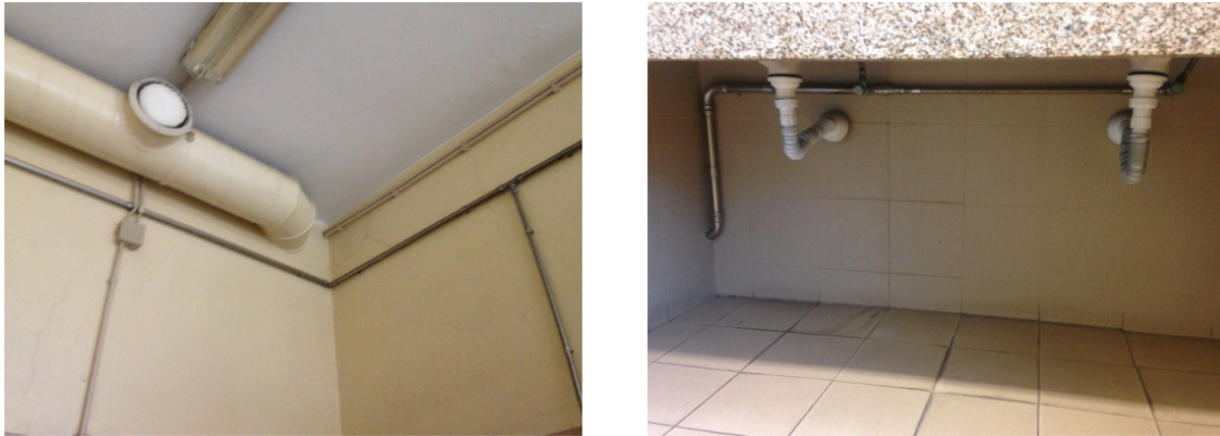
Figura 41 - Tubagem pelo exterior das paredes
