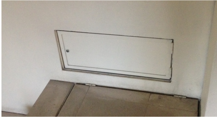
Figura 50 - Ponto de abastecimento de água da IS
