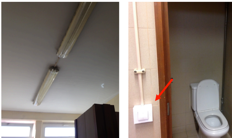
Figura 53 - Sistema de iluminação instalado na IS
