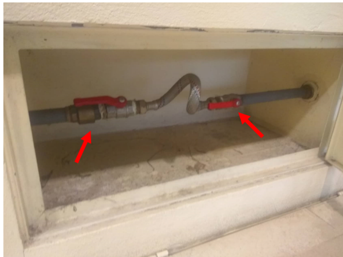
Figura 52 - Local de instalação do contador inteligente
