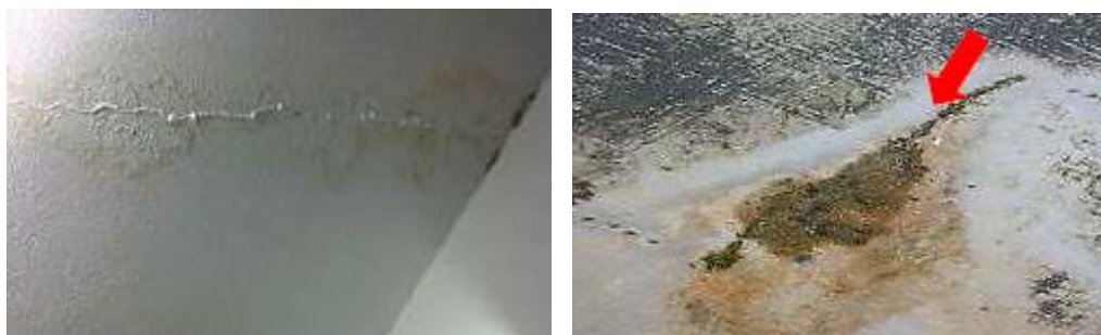
Figura 4.34 – Fissuração no paramento interior (esquerda) e fissuração da membrana de impermeabilização (direita).
