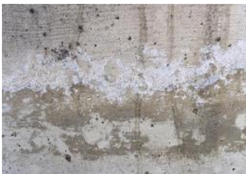
Figura 3.41 – Exemplo de eflorescências no betão à vista. (Coelho, 2015)
