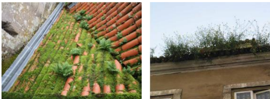
Figura 4.25 – Acumulação de musgo e líquenes, assim como crescimento exagerado de vegetação no beirado. (Brito, 2004; Lourenço, [s.d.])
