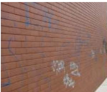
Figura 3.40 – Exemplo de vandalismo numa parede de tijolo face à vista. (Resende, 2017)
