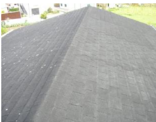
Figura 4.13 – Cobertura com falta de ventilação por insuficiência de elementos específicos. (Garcez, 2009)
