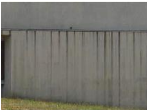
Figura 3.32 – Manchas de escorrimento no sistema ETICS. (Lopes, 2005)
