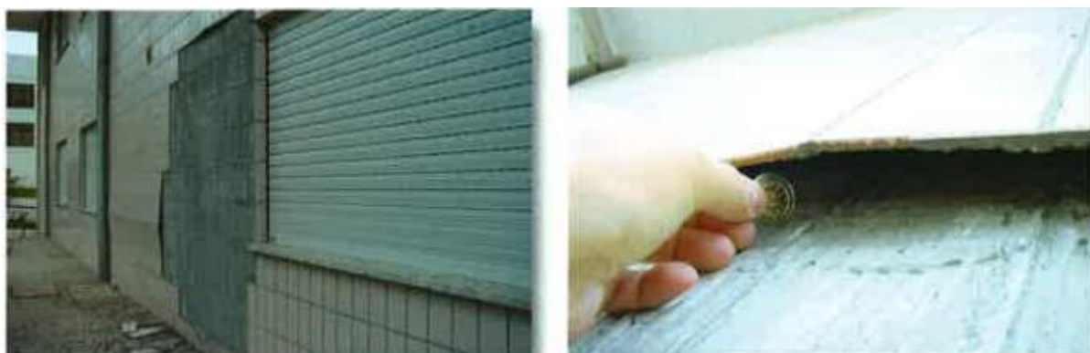
Figura 3.2 – Descolamento com empolamento grave, indicando elevados calores de expansão irreversível. (Sousa, Freitas e Silva, 2003)
