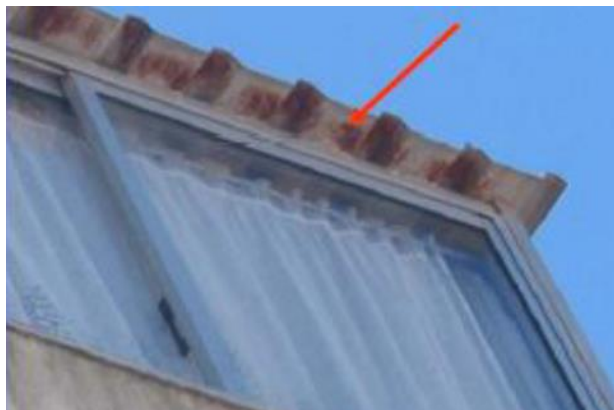
Figura 4.27 – Corrosão bimetalica por contacto direto entre o aço e o alumínio. (Garcez, 2009)
