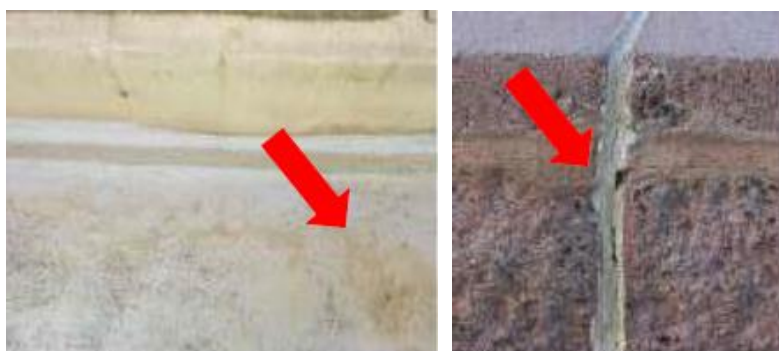
Figura 4.32 – Membrana líquida de impermeabilização envelhecida devido à radiação solar (esquerda) e deterioração de junta de dilatação devido à exposição solar (direita). (Conceição, 2015)
