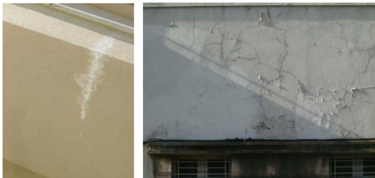
Figura 3.16 – Exemplos de eflorescências em fachadas. (Lourenço, [s.d.]; Rosa and Martins, 2005)
