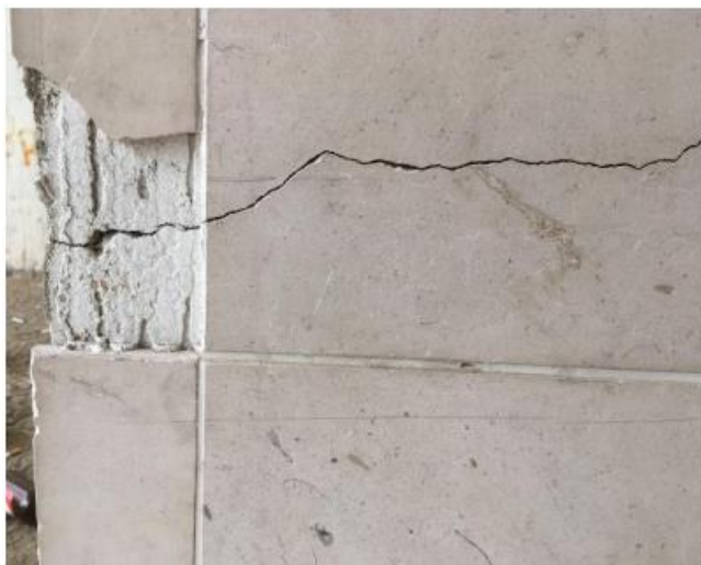
Figura 3.3 – Fissuração do elemento cerâmico e consequente descolamento. (Cassiano, 2017)
