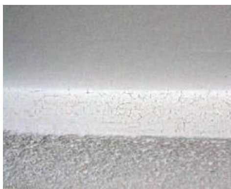
Figura 3.20 – Fissuração da película de tinta numa fachada.
