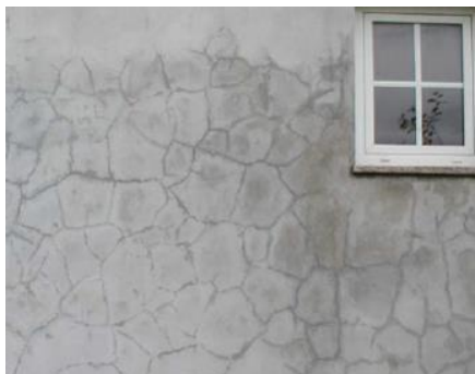
Figura 3.45 – Exemplo de uma fissuração mapeada. (Pinheiro, 2019)
