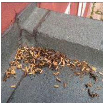
Figura 4.39 – Acumulação de detritos junto à embocadura de tubo de queda. (Conceição, 2015)
