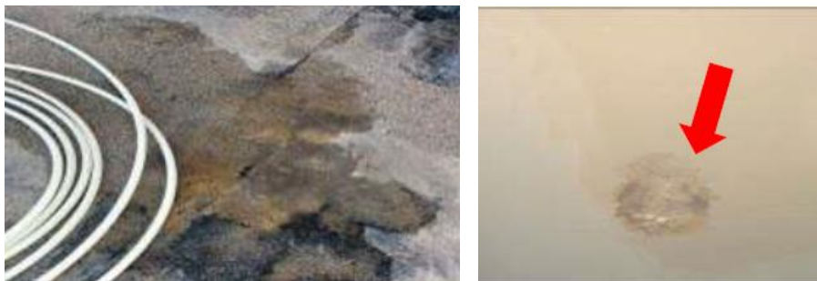
Figura 4.43 – Manchas de humidade na superfície (esquerda) e condensação no paramento interior do teto de uma habitação (direita). (Araújo, Brito e Júlio, 2008; Conceição, 2015)
