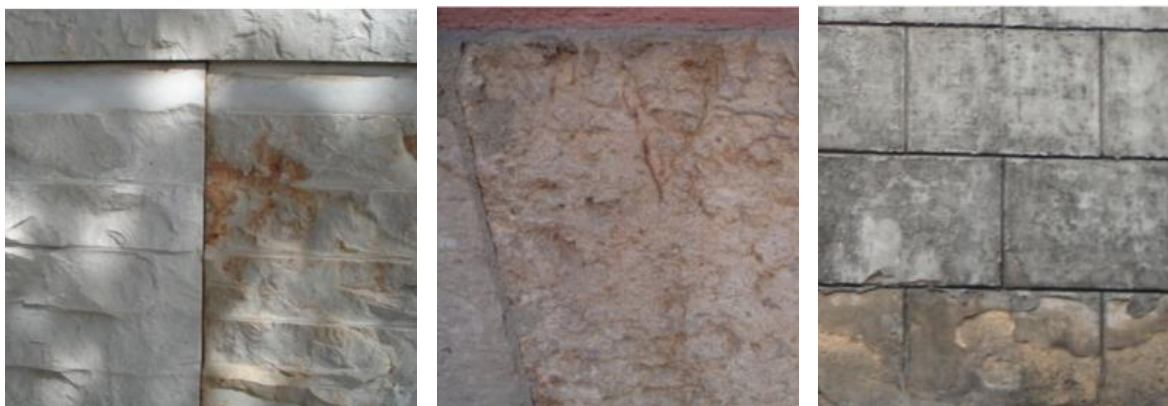
Figura 3.8 – Degradação do material: erosão, alveolização e esfoliação. (Silva, 2009)
