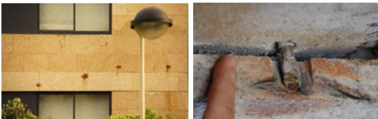
Figura 3.11 – Manchas nos locais das ancoragens dos elementos pétreos de uma fachada. (Lourenço, [s.d.])
