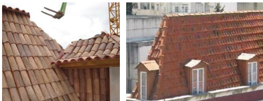
Figura 4.12 – Exemplo de duas coberturas com revestimentos de telhas cerâmicas com inclinação excessiva. (Brito, 2004; Lourenço, [s.d.]
