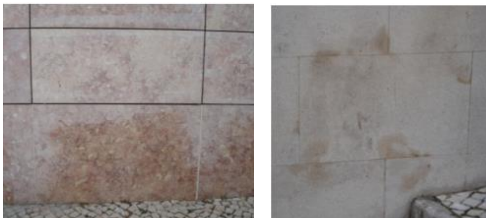
Figura 3.7 – Machas localizadas (devido ao material de colagem e humidade ascensional). (Silva, 2009)
