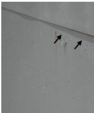
Figura 3.48 – Exemplo de defeito entre painéis de betão à vista de uma fachada. (Silva, 2015)
