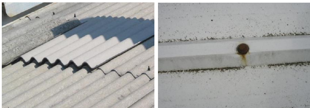
Figura 4.30 – Ausência de fixações (esquerda) e corrosão da peça de fixação (direita).
