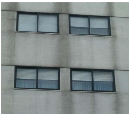
Figura 3.19 – Exemplo de fachada que apresenta sujidade. (Rosa e Martins, 2005)
