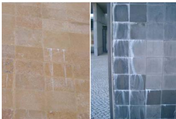
Figura 3.6 – Revestimento em amarelo de negrais com sais (esquerda) e revestimento em ardósia com ocorrência de sais (direita). (Brito, 2004)
