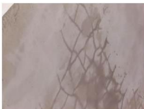
Figura 3.14 – Fissuração do revestimento de forma mapeada. (Lourenço, [s.d.])
