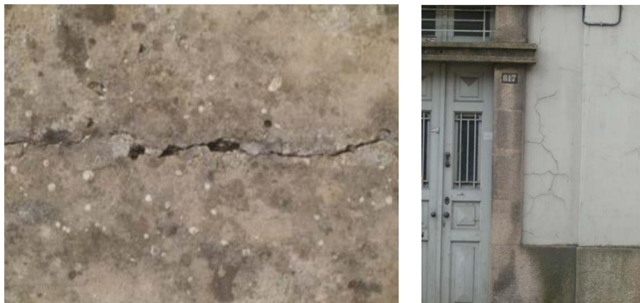
Figura 3.13 – Fendilhação do reboco (esquerda) e fissuração de uma parede (direita). (Rosa e Martins, 2005)
