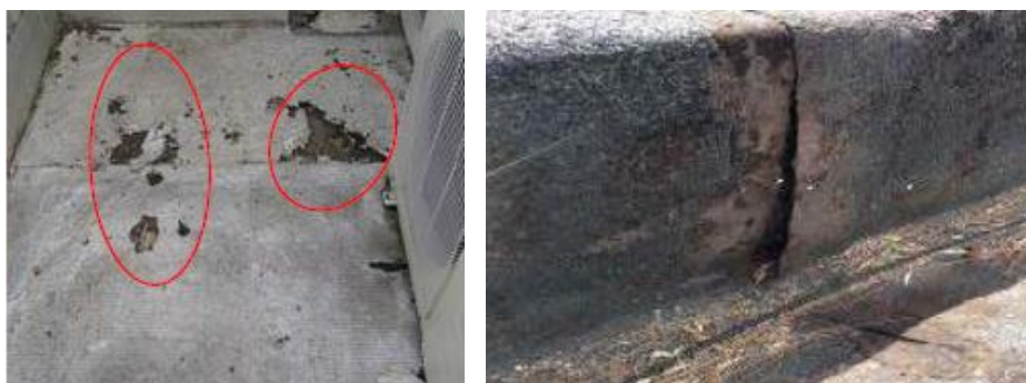
Figura 4.36 – Rasgamento da tela betuminosa auto-protegida (esquerda) e descolamento da junta de sobreposição das membranas numa platibanda (direita). (Araújo, Brito e Júlio, 2008; Conceição, 2015)
