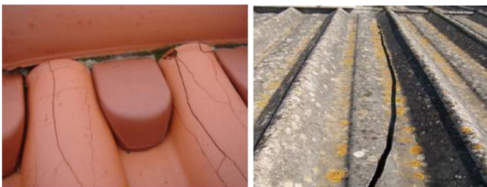
Figura 4.16 – Exemplo de uma telha fissurada (esquerda) e fratura em revestimento de fibrocimento (direita). (Garcez, 2009; Lourenço, [s.d.]
