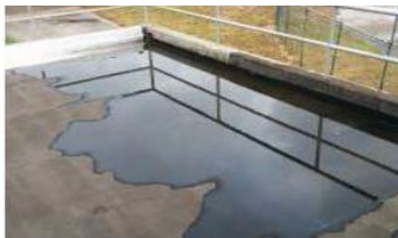
Figura 4.40 – Empoçamento devido a inclinação insuficiente. (Conceição, 2015)
