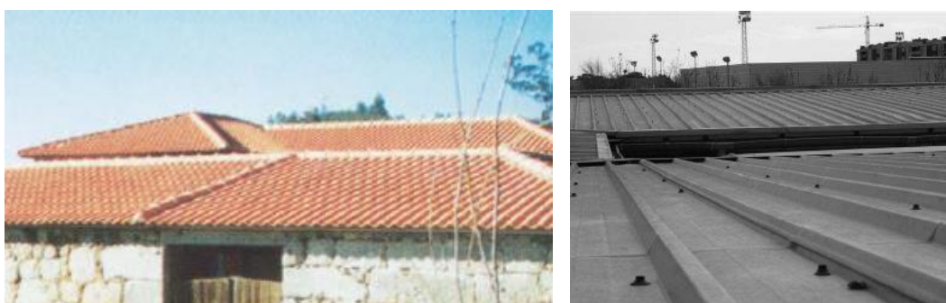
Figura 4.11 – Exemplo de uma cobertura com revestimento de telhas cerâmicas com inclinação insuficiente (esquerda) e cobertura com inclinação insuficiente de chapas galvanizadas (direita). (Brito, 2004; Garcez, 2009)
