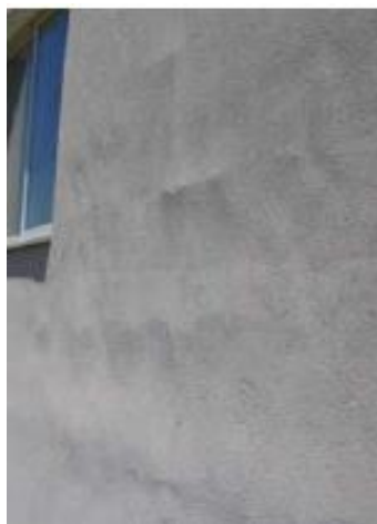
Figura 3.28 – Empolamento das placas do sistema ETICS. (Lopes, 2005)
