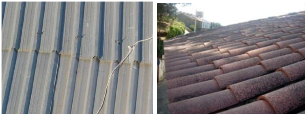
Figura 4.15 – Desalinhamento de revestimentos metálicos (esquerda) e telhas desalinhadas por falta de fixação (direita). (Lourenço, [s.d.])
