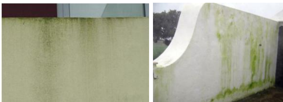
Figura 3.18 – Exemplos de fachadas com sujidade, como algas e fungos. (Lourenço, [s.d.]
