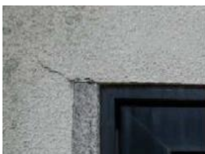
a) Fissuração diagonal num canto de uma janela.
