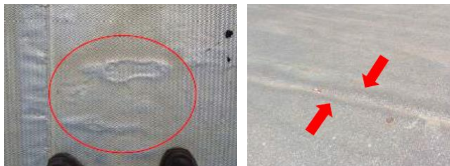
Figura 4.38 – Empolamento de uma tela betuminosa auto-protégida com folhas de alumínio (esquerda) e empolamento de uma membrana de impermeabilização em zona corrente (direita). (Araújo, Brito e Júlio, 2008; Conceição, 2015)
