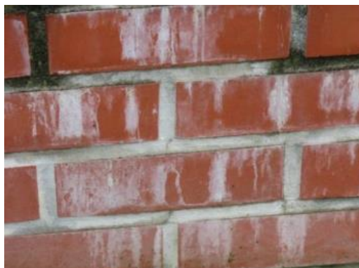
Figura 3.36 – Exemplo de eflorescências numa parede em tijolo face à vista. (Resende, 2017)
