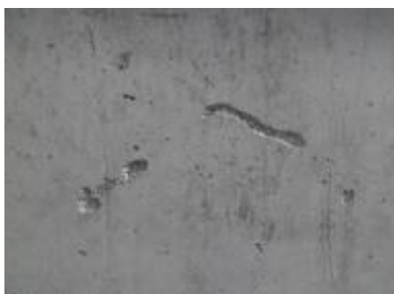
Figura 3.43 – Exemplo de desgaste de uma superfície de betão à vista. (Silva, 2015)
