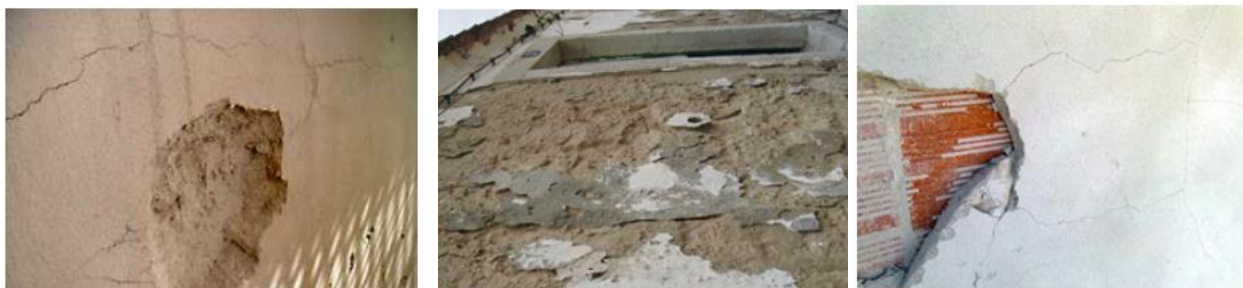
Figura 3.15 – Exemplos de fachadas com perda de aderência do reboco (descolamento, abaulamento e destacamento). (Rosa e Martins, 2005)
