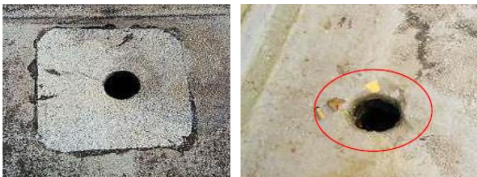
Figura 4.44 – Deficiente execução do tubo de queda (esquerda) e inexistência de ralo de pinha (direita). (Conceição, 2015)
