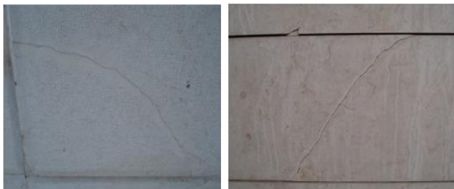
Figura 3.10 – Fissuração do elemento pétreo. (Silva, 2009)
