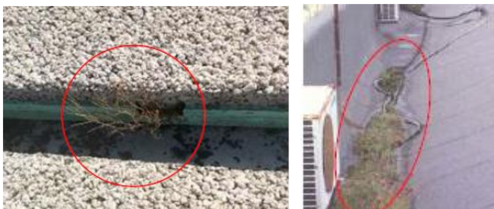
Figura 4.41 – Desenvolvimento de vegetação sobre a cobertura e junto a uma platibanda. (Araújo, Brito e Júlio, 2008; Conceição, 2015)
