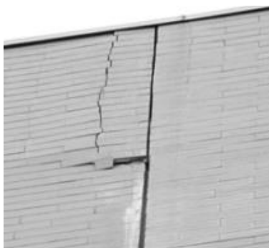
Figura 3.37 – Exemplo de deformação de junta de dilatação e consequente danificação dos tijolos.
