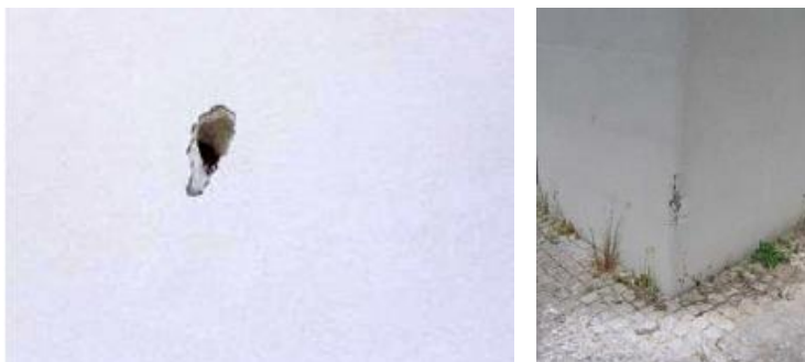
Figura 3.33 – Perfuração do sistema ETICS (esquerda) e choque provocado por um veículo (direita). (Lopes, 2005; Lourenço, [s.d.]
