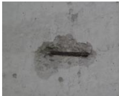
Figura 3.47 – Exemplo de descasque com armadura visível. (Coelho, 2015)
