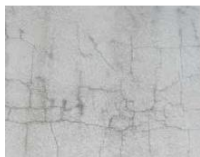
c) Fissuração mapeada.
