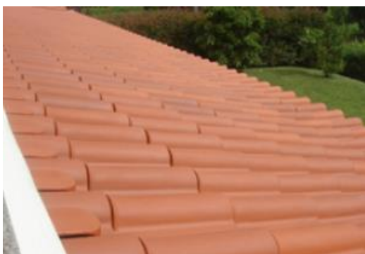
Figura 4.17 – Diferença de tonalidade nas telhas cerâmicas. (Lourenço, [s.d.]; Silva et al. , 1998))
