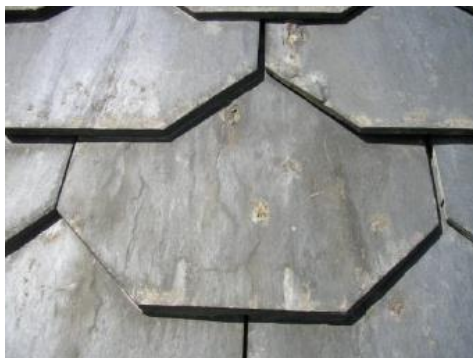
Figura 4.18 – Manchas de ferrugem em soletos de ardósia. (Garcez, 2009)
