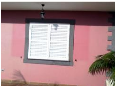
Figura 3.24 – Descoloração por ação dos raios ultravioleta (UV). (Lourenço, [s.d.])
