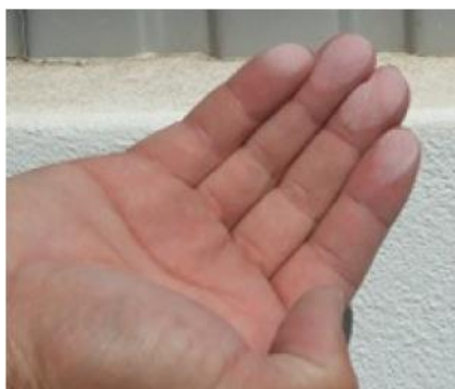
Figura 3.21 – Imagem exemplo de pulverulência de um revestimento de uma fachada. (Lourenço, [s.d.]
