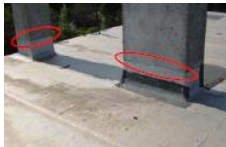
Figura 4.48 – Deficiência de um remate da impermeabilização em chaminé. (Lopes, 2002)
