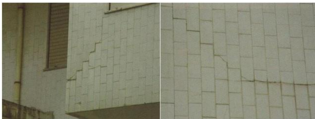
Figura 3.4 – Fissuração sobre parede deformada devido a movimentos da estrutura, mais visível devido à sujidade acumulada. (Bento, 2010)
