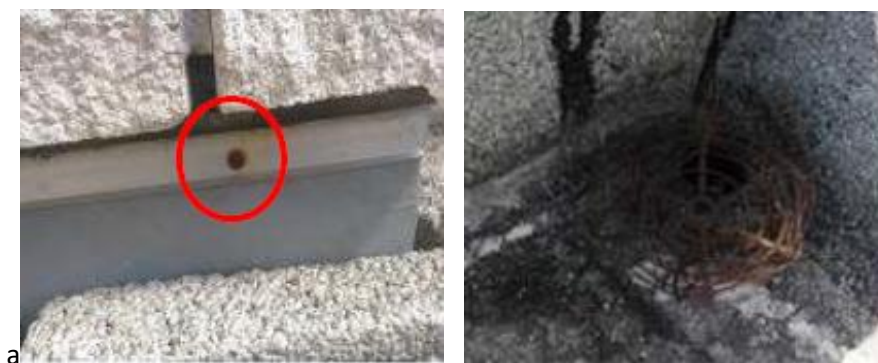
Figura 4.42 – Corrosão numa peça de fixação do rufo (esquerda) e corrosão do ralo de embocadura (direita). (Araújo, Brito e Júlio, 2008; Conceição, 2015)
