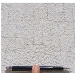
b) Microfissuração reticulada.
