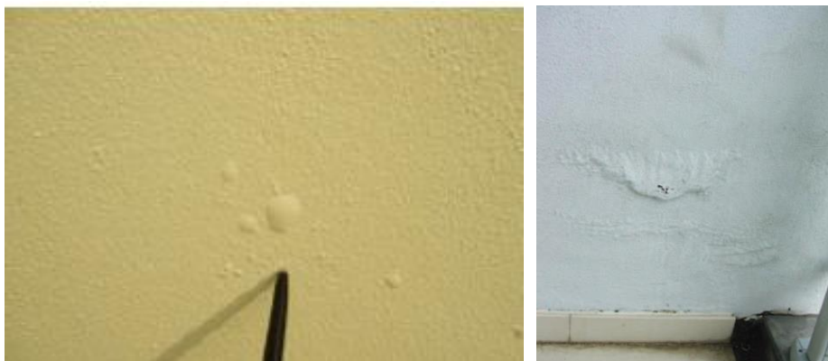
Figura 3.22 – Exemplos de empolamento do revestimento de pintura em fachadas exteriores. (Cordeiro, 2011; Lourenço, [s.d.]
