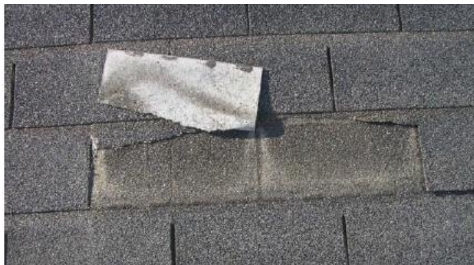
Figura 4.14 – Descolamento em revestimento de telhas asfálticas. (Garcez, 2009)
