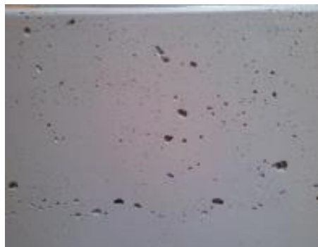
Figura 3.44 – Exemplo de bolhas de pele numa superfície de betão à vista. (Silva, 2015)
