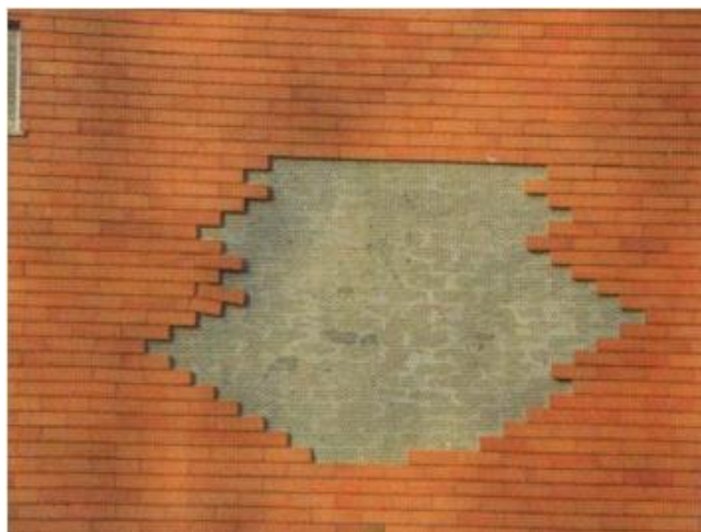
Figura 3.1 – Descolamento localizado extenso, sem empolamento aparente. (Sousa, Freitas e Silva, 2003)
