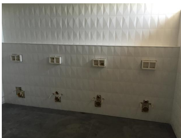
Figura 29 – Cerâmico aplicado numa das instalações sanitárias públicas do piso 0 do edifício principal do hotel.
