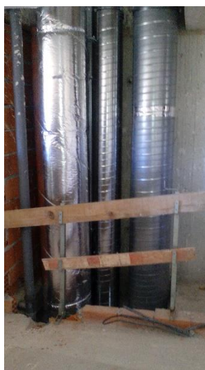
Figura 23 – Conduatas circulares rígidas e flexíveis da rede de ventilação mecânica do edifício principal do hotel.
