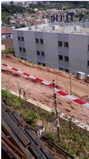
Figura 18 – Fitas sinalizadoras colocadas no acesso entre o edifício principal do hotel e o edifício do spa .
