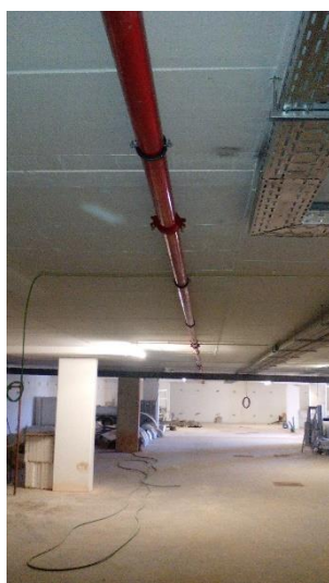
Figura 35 – Tubagem da rede de incêndio armada.
