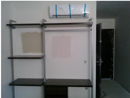
Figura 40 – Unidade interior mural instalada na parede de um quarto do hotel.
