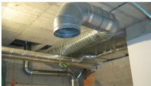
Figura 39 – Conduas do sistema de ventilação mecânica do edifício principal do hotel.
