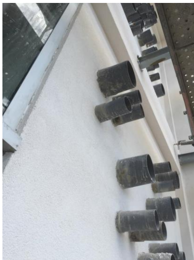
Figura 33 – Primário aplicado numa das paredes do anexo das salas de refeições e de eventos do edifício principal do hotel.
