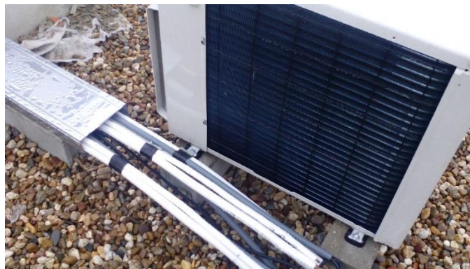
Figura 42 – Unidade exterior localizada na cobertura do hotel.
