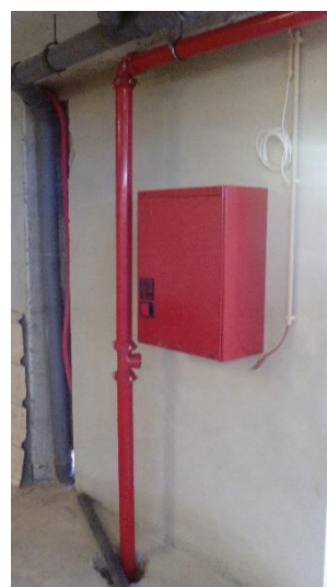
Figura 36 – Carretel e tubagem da rede de incêndio armada.
