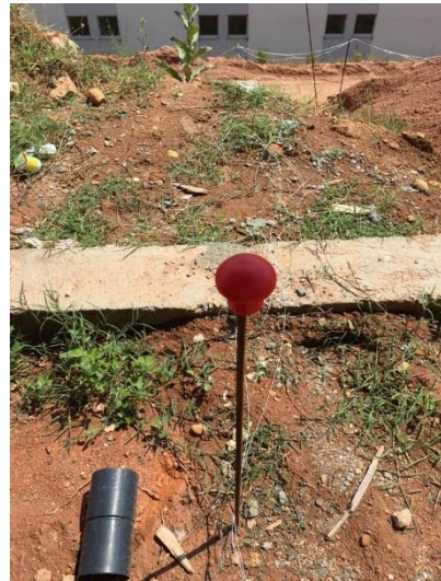
Figura 19 – Cogumelos protetores dos varões de aço.
