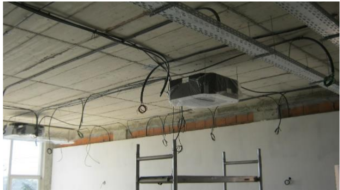
Figura 41 – Unidade interior cassete de 4 vias instalada na sala de refeições.
