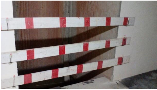
Figura 16 – Guarda-corpos no patamar da caixa de elevador no piso -1.
