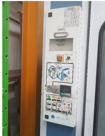
Figura 53 - Quadro de comandos
