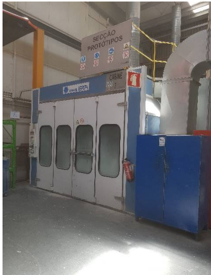
Figura 52 - Porta da cabina de pintura
