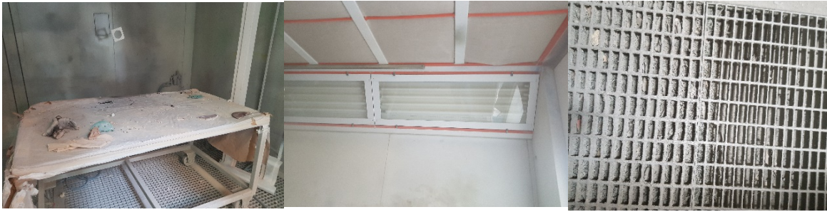
Figura 40 - Estado da Estufa de Pintura antes da Limpeza
