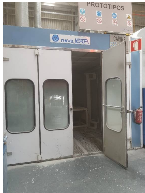
Figura 25 - Estufa de Pintura
