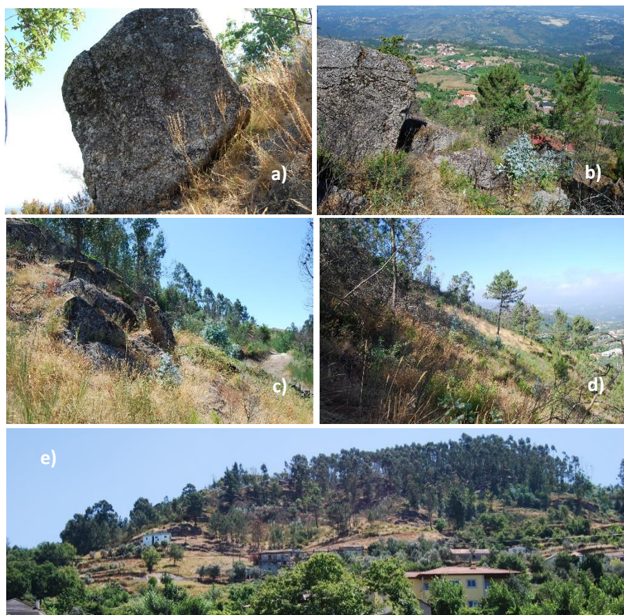
Figura 39 - Vertente rochosa de S. Simão: a) e b) blocos instáveis, c) e d) declives acentuados e e) vista panorâmica contemplando as habitações no sopé (Machado, 2016).
