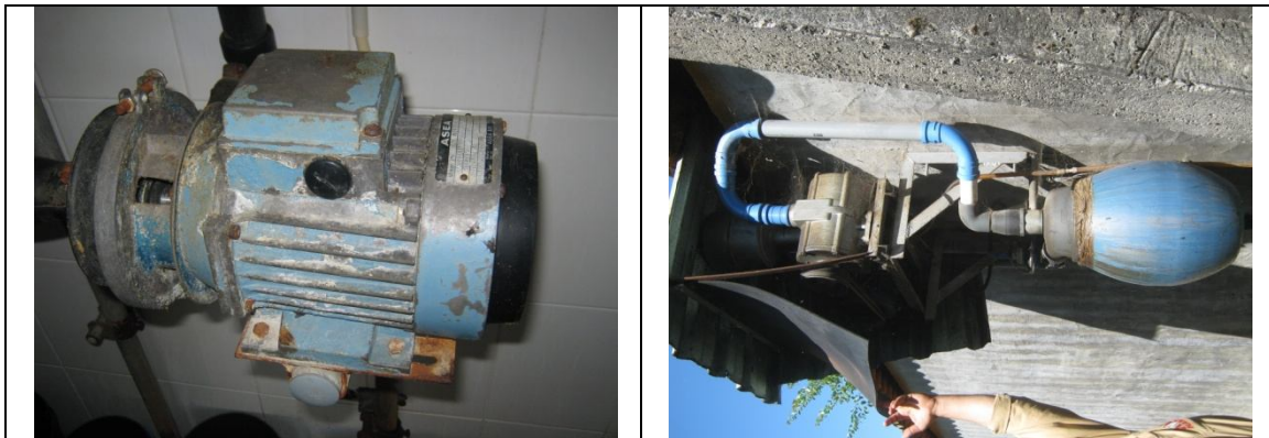
Figura 7.6 – Motores elétricos presentes na propriedade
