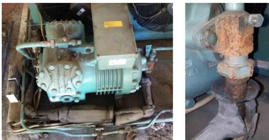
Figura 4.8 – Isolamentos deteriorados e presença de ferrugem.
