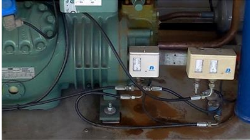
Figura 4.9 – Fuga de óleo.
