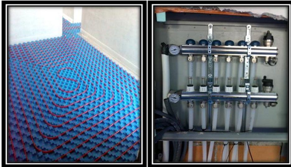
Figura 4 - Piso radiante hidráulico (à esquerda) e colector de ida e retorno do circuito hidráulico.
