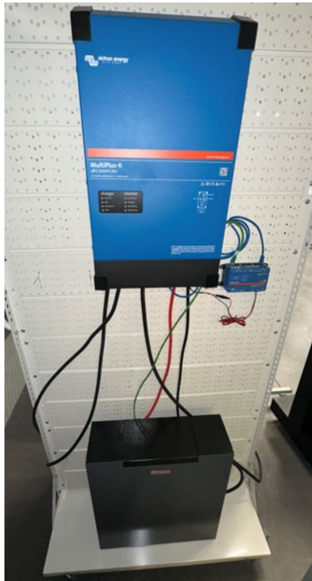
Figura 4.4: Sistema de armazenamento de energia elétrica X-Energy Lab.
