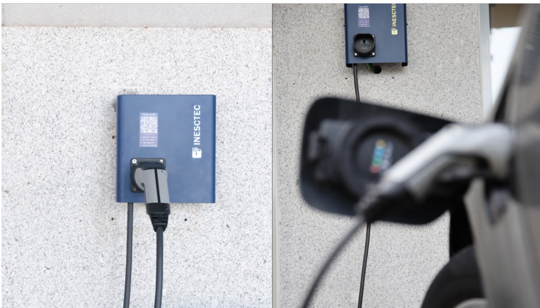
Figura 4.5: Carregador elétrico INESC TEC.
