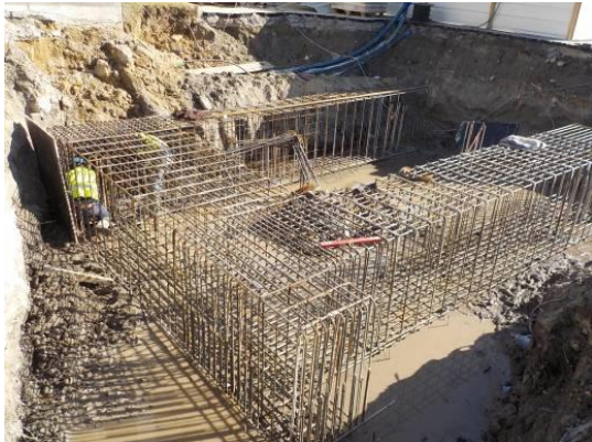
Fotografia 4.11 - Colocação de armaduras para proceder à execução da caixa de escadas localizada entre o eixo 28 e 27 (10-02-2015)
