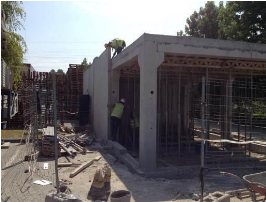
Fotografia 5.39 - Colocação de painéis em betão armado pré-fabricados lisos na zona a ampliar do edifício de resíduos sólidos (05-06-2015)
