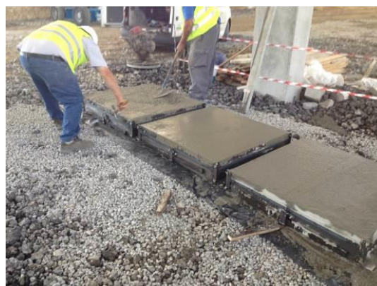
Fotografia 5.36 - Betonagem das amostras para se proceder ao ensaio de retração do betão ao longo dos primeiros 21 dias (27-05-2015)
