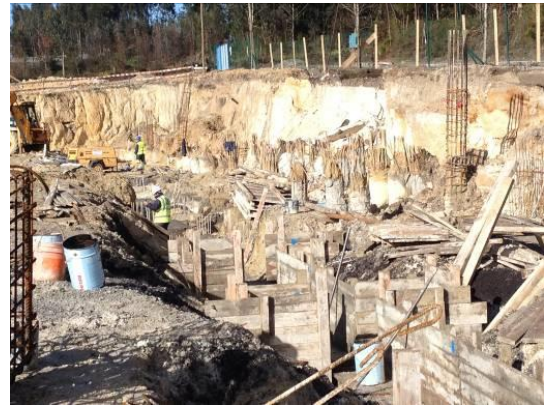
Fotografia 5.6 - Evolução dos trabalhos de cofragem e colocação de armaduras para se proceder à betonagem dos elementos construtivos no alinhamento D (25-02-2015)
