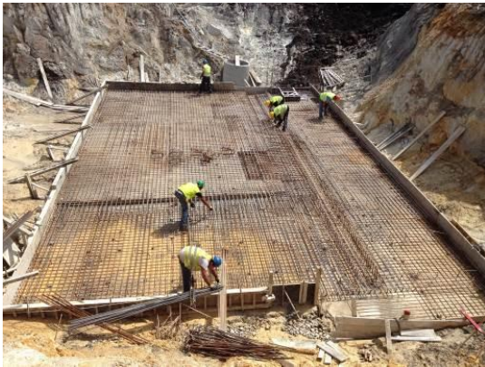
Fotografia 5.27 - Colocação de armadura para se proceder à execução da fundação do reservatório (07-05-2015)
