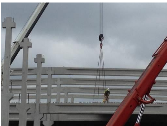
Fotografia 5.21 - Vista geral de vigas de cobertura em betão armado pré-fabricadas, colocadas desde o eixo 27 até ao eixo 24 (16-04-2015)
