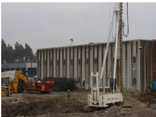
Fotografia 4.5 - Execução de fundações indiretas por estacas moldadas no terreno, pelo método do trado contínuo
