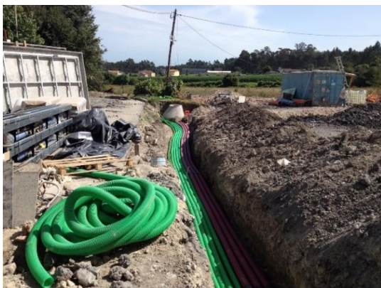
Fotografia 5.53 - Vista geral dos tubos de cabos de eletricidade (17-07-2015)
