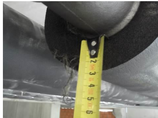
Fotografia 5.75 - Isolamento de tubagem em conformidade
