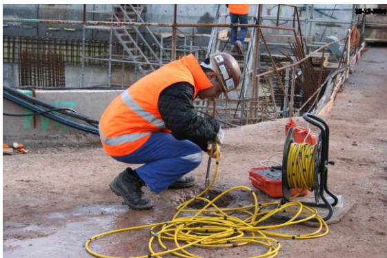
Leitura do inclinómetro (entre o poço 1 e 2)
