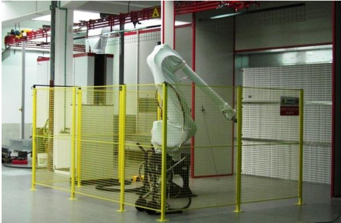
Figura 23 - Barreiras de proteção (fonte: Logismarket)
