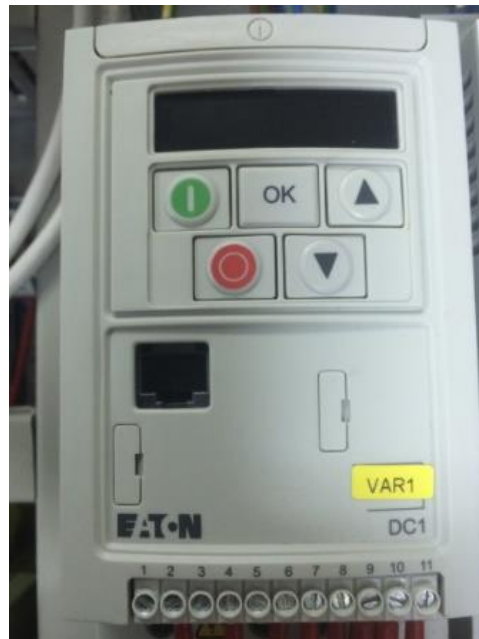
Figura 17: Conversor de frequência
