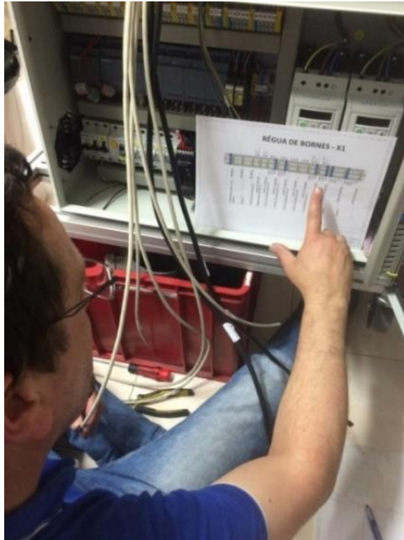
Figura 40:Ligação do quadro elétrico principal
