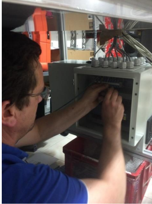
Figura 37:Ligação do quadro das válvulas “on/off”
