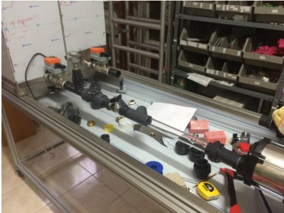
Figura 33: Linha de aspiração bomba 1
