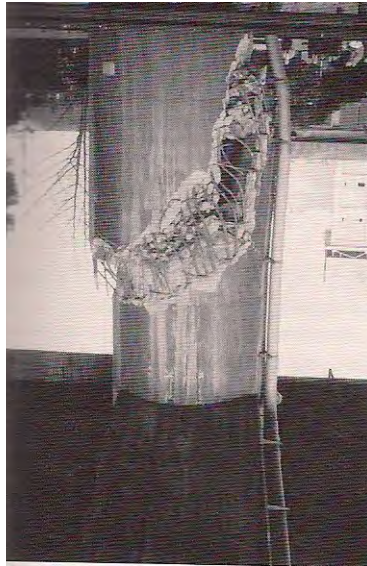
Figura 146 – Danificação de um pilar por acção sísmica
