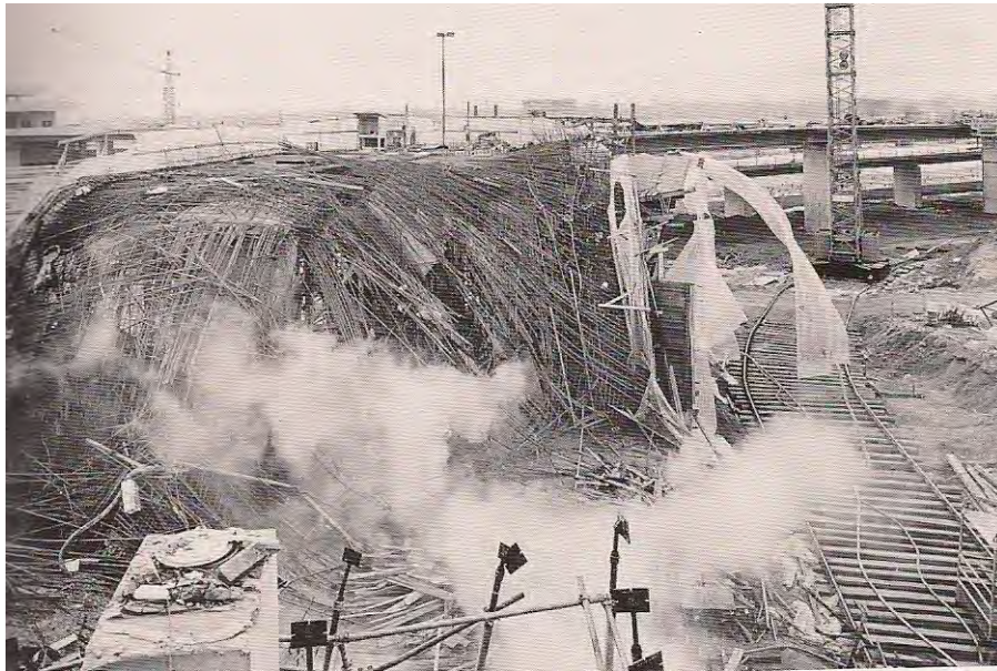
Figura 147 – Queda de estrutura por falha no cimbrio
