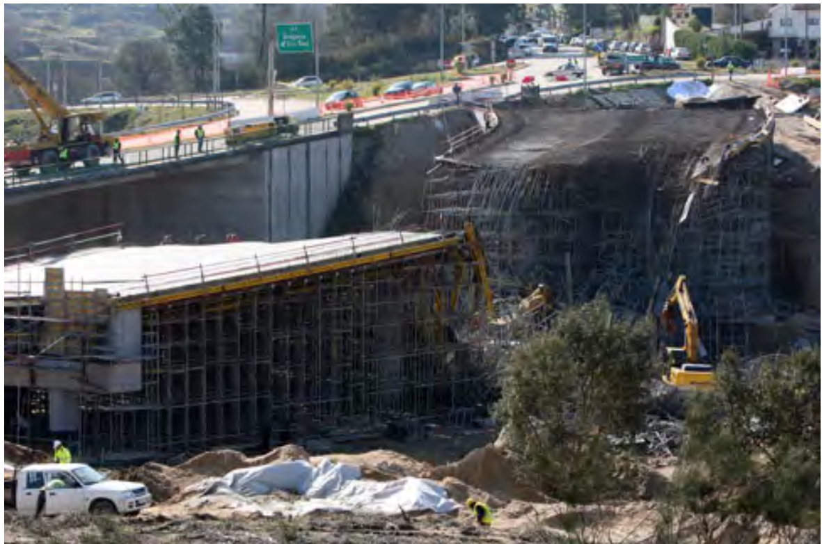
Figura 78 – Queda de um cimbra
