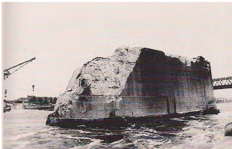
Figura 136 – Pormenor do maciço após o colapso
