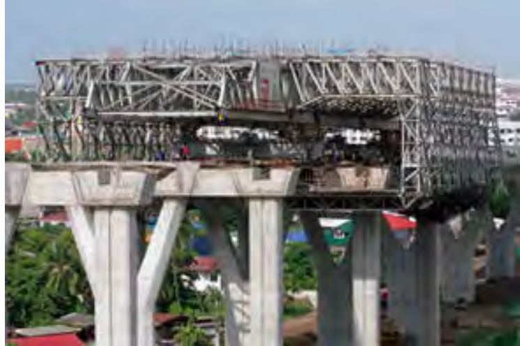
Figura 103 – Viga de lançamento superior
