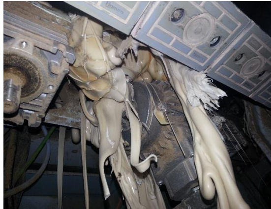
Figura 31 - Motor afetado por derrame de cola
