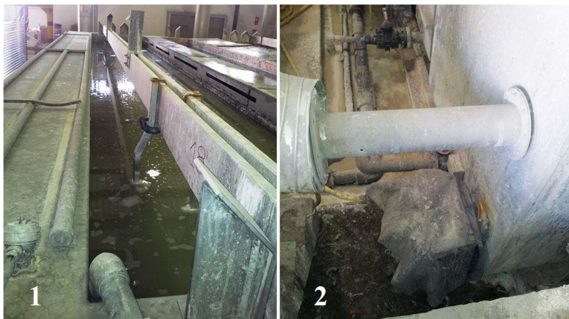
Figura 23 – 1. Tanque de desengorduramento do alumínio com um atado de alumínio; 2. Queimador e conduta dos gases de exaustão.
