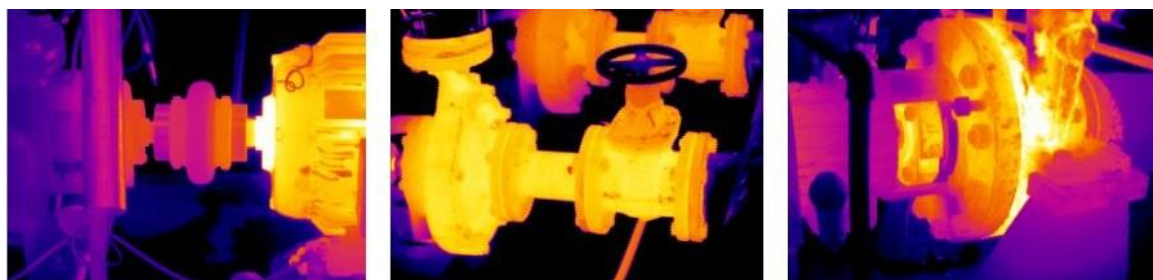
Figura 13 - Imagens termográficas de motores, válvulas e acoplamentos [23].
