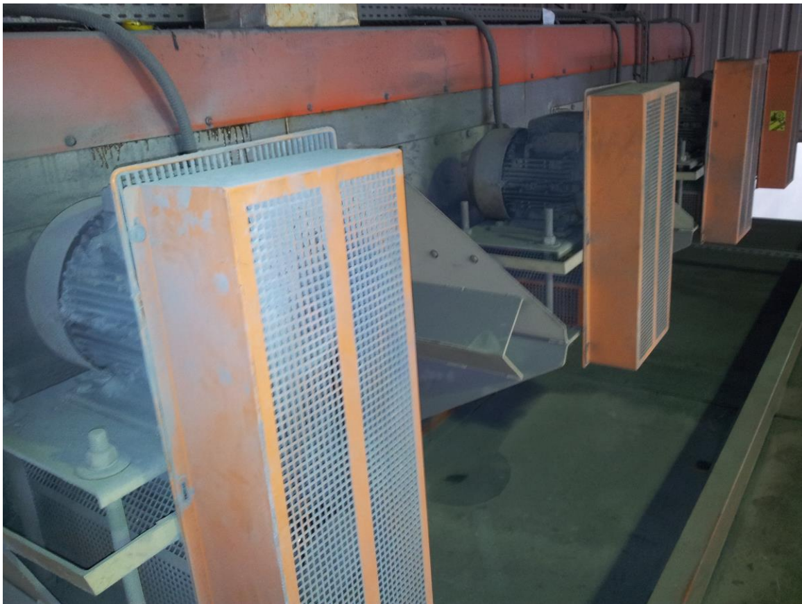
Figura 29 - Motores dos 4 ventiladores do forno de lacagem.
