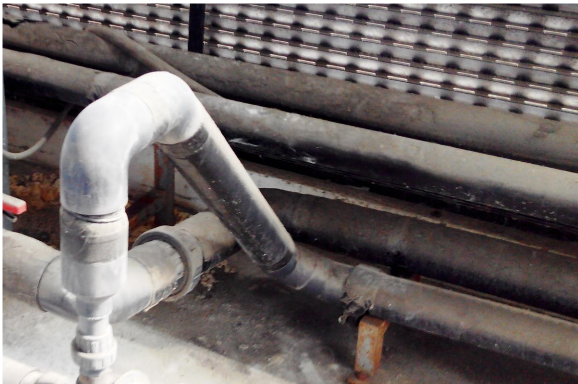
Figura 27 - Tubagens dos “banhos frios” dentro da unidade industrial.
