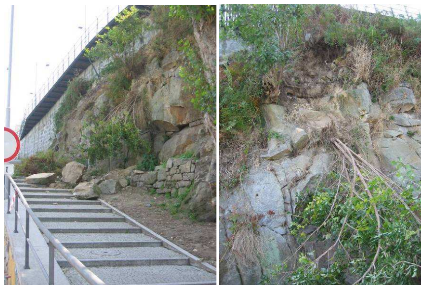
Figura 50 – Aspectos do talude da escadaria e dos blocos resultantes da queda de Agosto de 2008.
