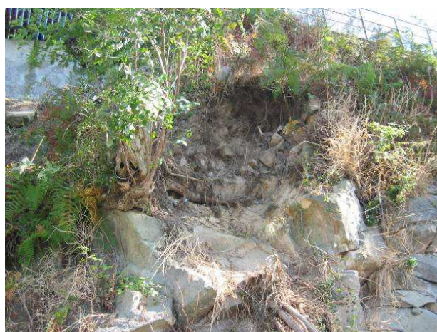
Figura 51 – Pormenor do local do talude do qual se destacaram os blocos resultantes da queda de Agosto de 2008.
