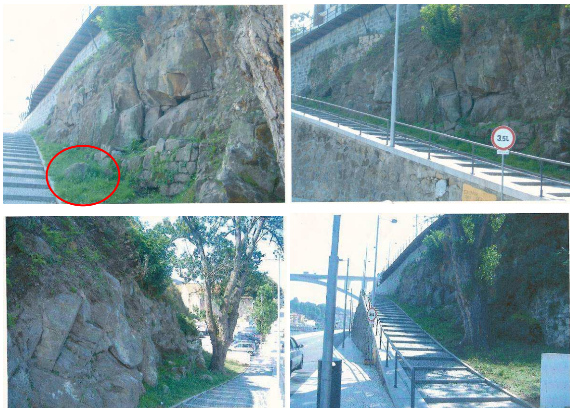
Figura 49 - Fotos do talude escadaria (Setembro de 2007), para ilustrar a exposição referida. O círculo vermelho representa um dos blocos das “pedras soltas” da queda de Julho de 2007.
