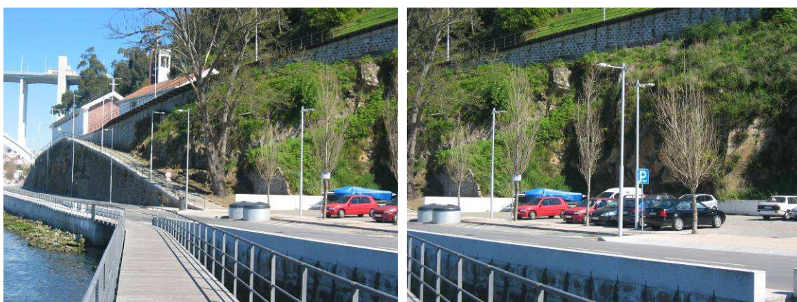
Figura 54 – Estado da vegetação no Talude da Escadaria (esquerda) e no Talude do Parque (direita).
