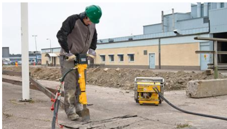
Figura 4.10 – Levantamento de pavimento com martelo pneumático ligado a compressor de ar portátil ( http://www.coptool.com ).
