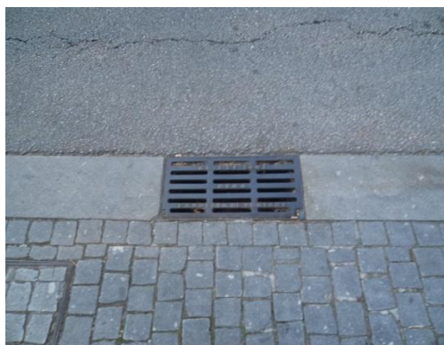
d) Sumidouro em alameda (SA2)
