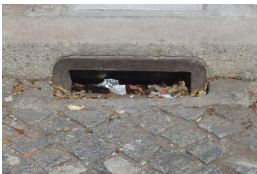
a) Sarjeta boca de lobo (SBL)
