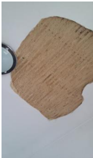
b) Estado inicial do teto
