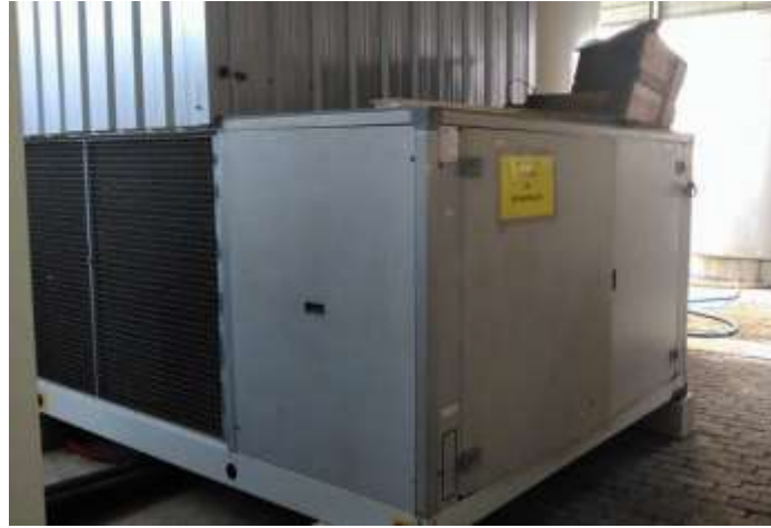
Figura 3.10 - Central de refrigeração.
