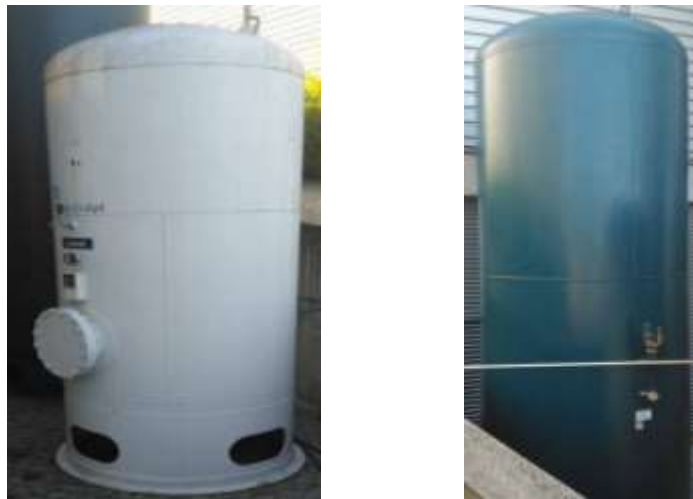
Figura 3.15 - Depósitos utilizados para o armazenamento do Azoto (esquerda) e ar (direita).
