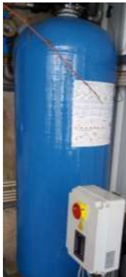
Figura 3.18 - Filtro multimédia utilizado.
