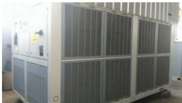
Figura 3.9 - Central de refrigeração.
