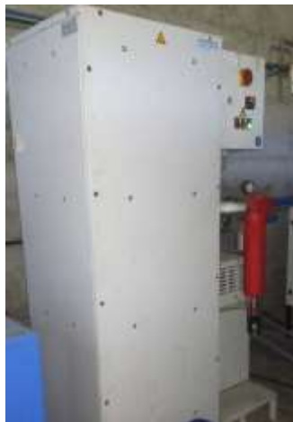
Figura 3.12 - Separador de Óleo utilizado.
