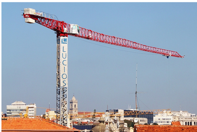
Figura 19- Grua torre IT2 [17]
