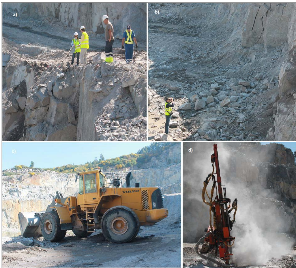
Figura 74 – Fases dos trabalhos de preparação da bancada para pega de fogo 2: a) geometria diagrama de fogo; b) varrimento com tecnologia laser da frente livre; c) regularização da superfície; d) Início da perfuração.
