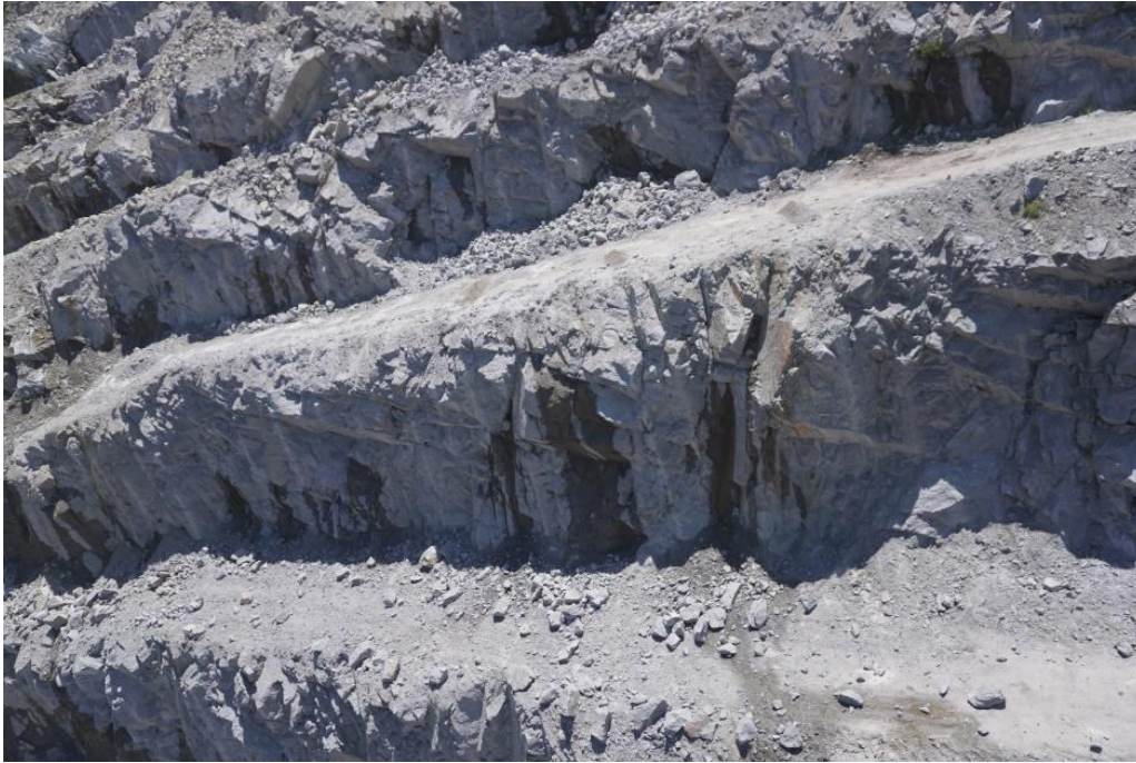
Figura 64 - Aspeto da bancada antes de se realizar o desmorte com detonadores não elétricos
