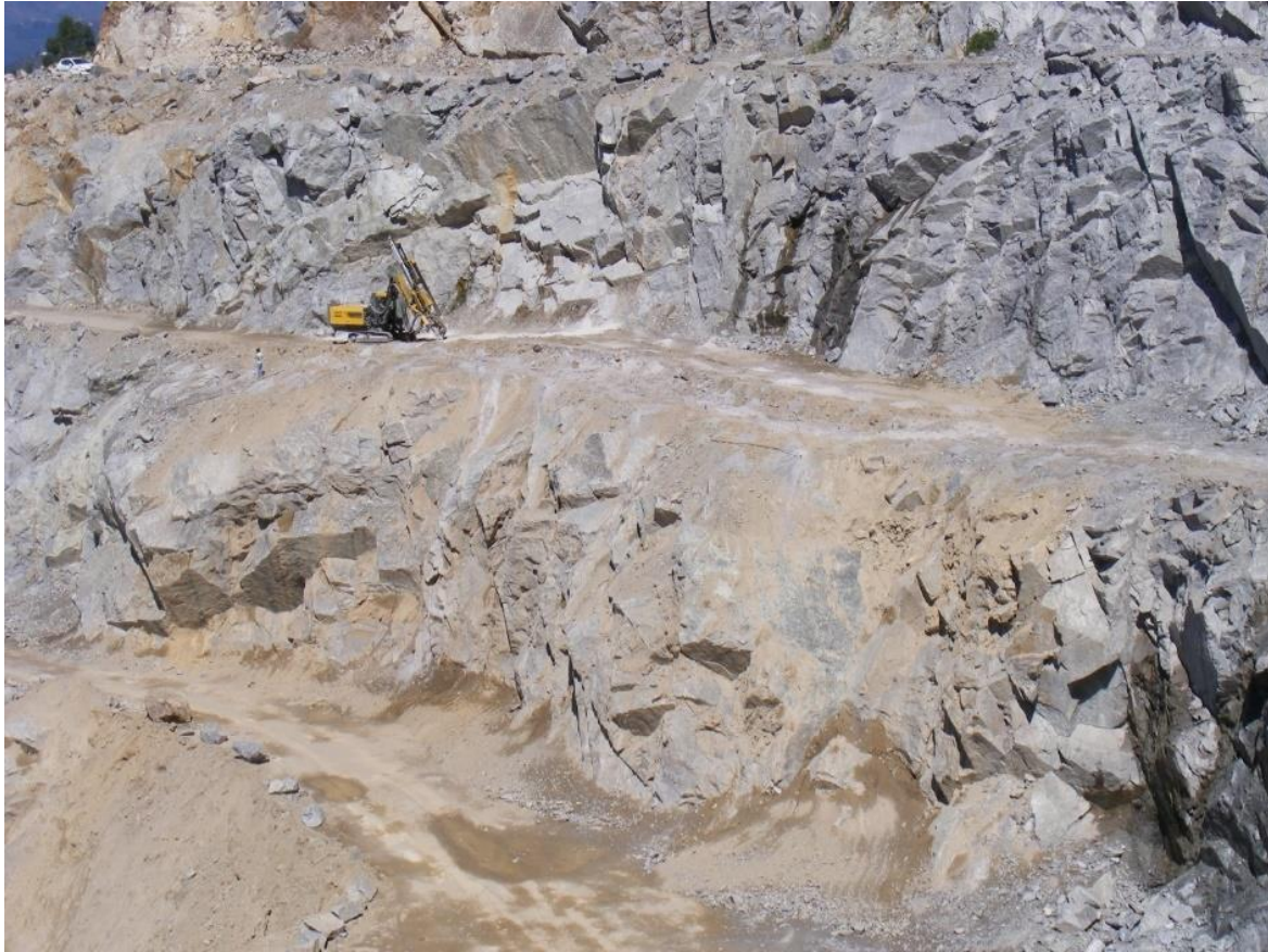
Figura 44 – Exemplo de crista de talude danificada (Fonseca, 2008)
