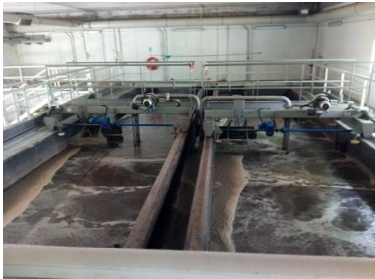
Figura 3-4- Equipamento de desarenamento e desengorduramento da ETAR de Esposende.
