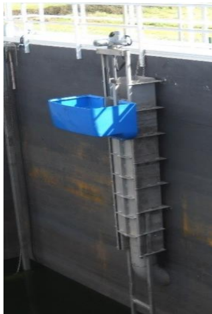
Figura 3-5- Decantador da ETAR de Esposende.
