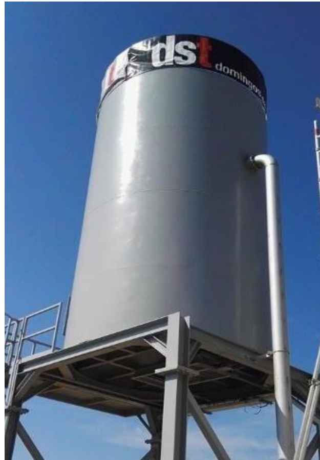
Figura 3-13- Silo de lamas.
