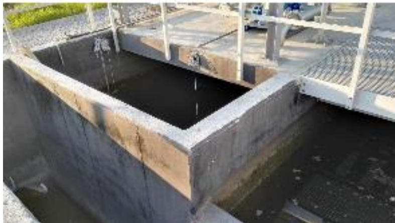
Figura 3-10 -Tanque de água de serviço.
