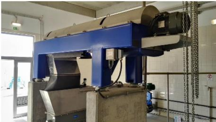
Figura 3-12- Equipamento utilizado na desidratação de lamas- Centrífuga.
