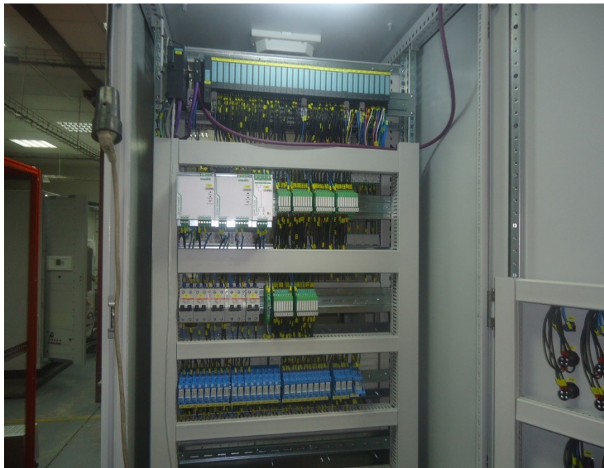
Figura 55 Interior da parte de comando do armário eléctrico de montante
