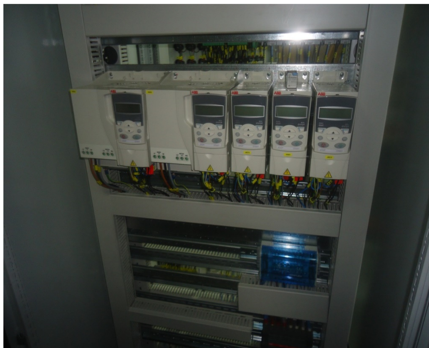
Figura 56 Interior da parte de potência armário eléctrico de montante
