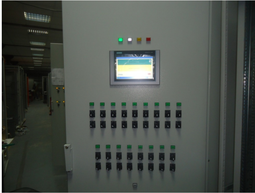
Figura 54 Frontal do armário eléctrico de montante
