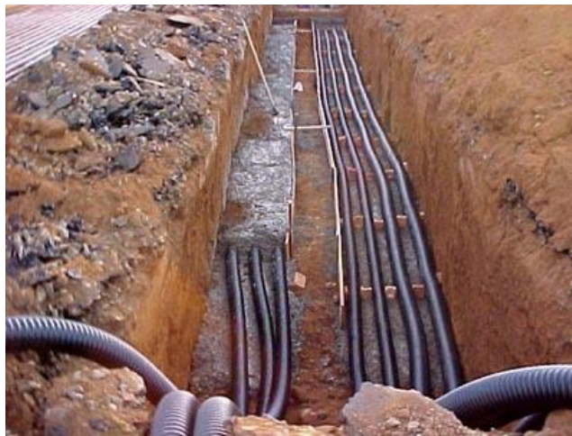
Figura 26 – Rede subterrânea de distribuição de energia eléctrica.
