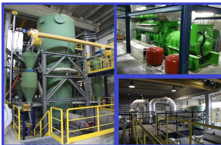
Figura 24. Planta de gasificación EQTEC Sorgenia SPA
