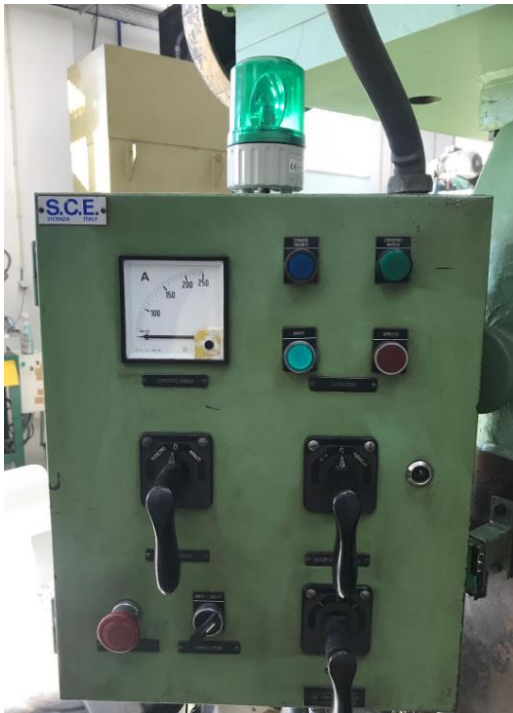
Figura 36 - Quadro de operação com botões de emergência e sensor luminoso.
