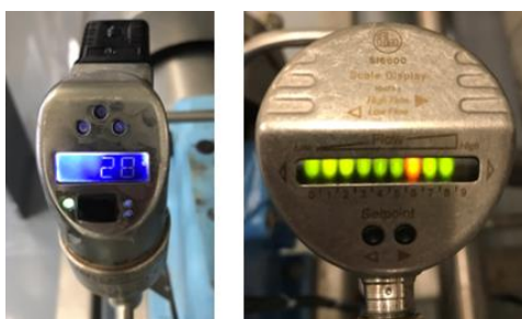
Figura 91 -Tipo de medidores de fluxo instalados na fábrica
