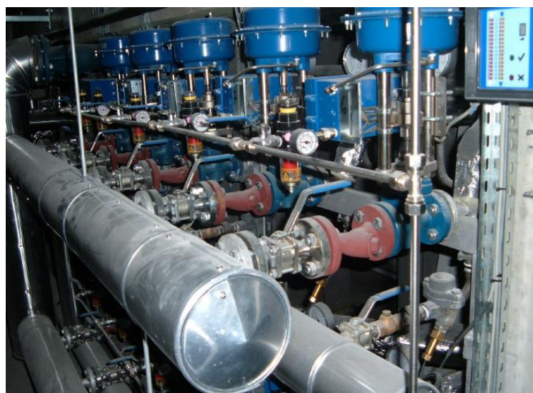
Figura 121 Inapal, pormenor "A" da estação de válvulas de controlo de vapor.
