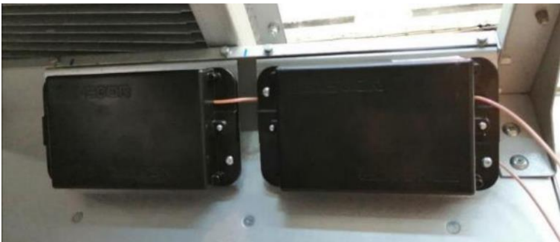
Figura 50 - Antenas no Compartimento de barramento.
