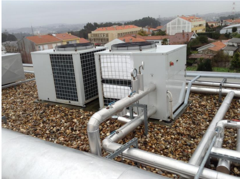
Figura 12- Bomba de Calor
