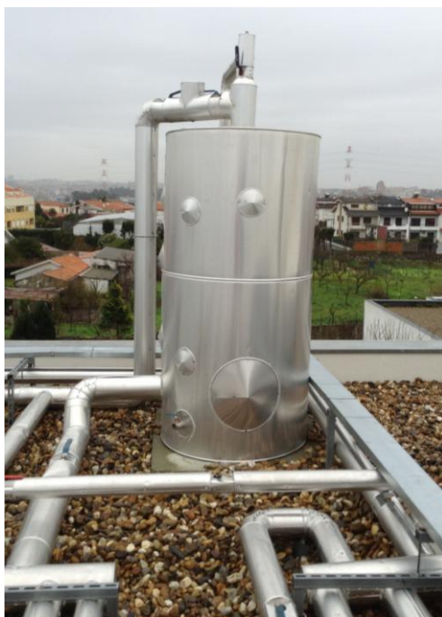
Figura 13- Depósito de Inércia
