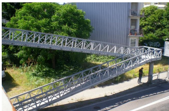
Figura 2.5 - Inclinação na rampa de acesso da passagem junto ao Tribunal
