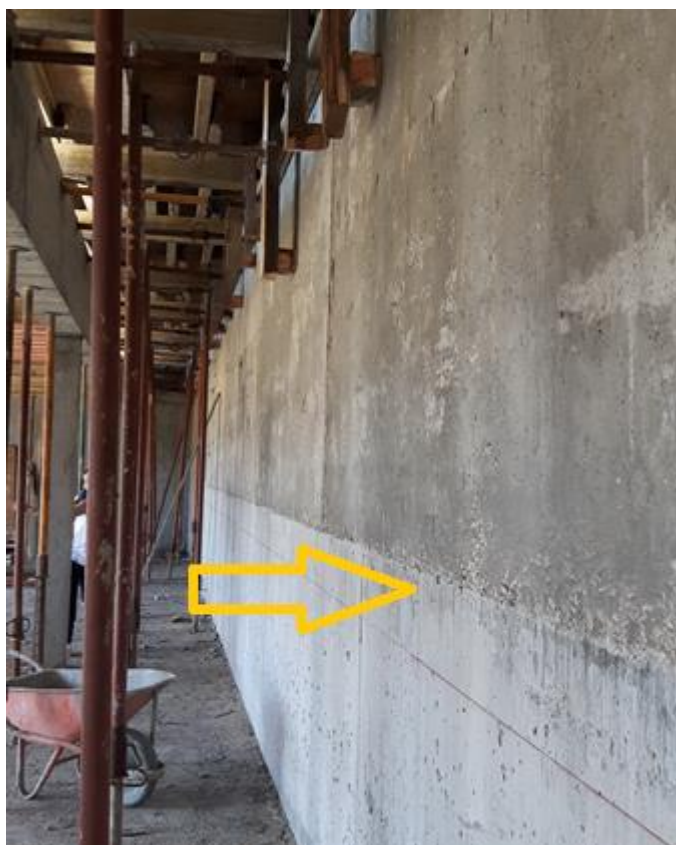
Figura 5.14 – Visualização de uma junta que evidencia a realização de duas fases de betonagens de um elemento
