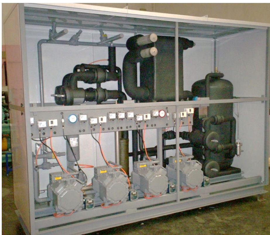
Figura 26: Central de refrigeração a funcionar com CO 2 em regime subcrítico.
