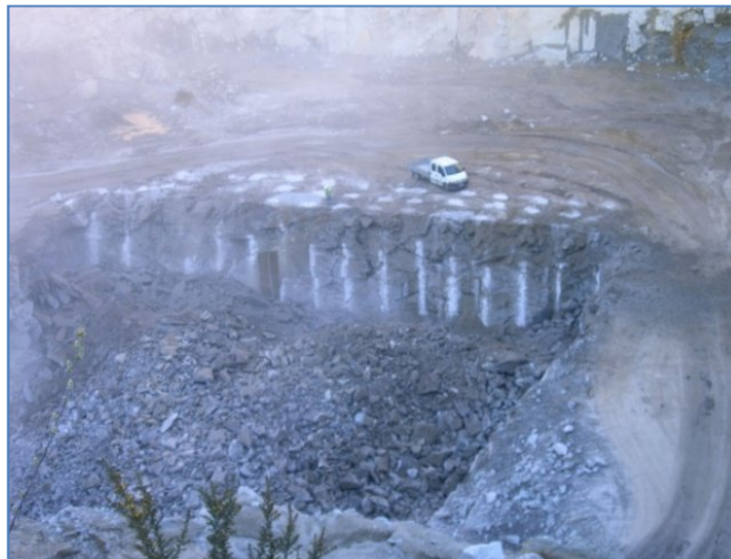
Figura 77 – Boa movimentação dos rebentamentos e definição das meias-canais na zona A. A definição das meias canas resulta essencialmente do alinhamento dos furos e da temporização utilizada.
