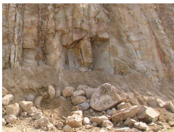
Figura 8 – Desvios de flexão versus excesso de escavação na frente livre, com aparecimento de explosivos na zona de interceptação com a frente livre.
