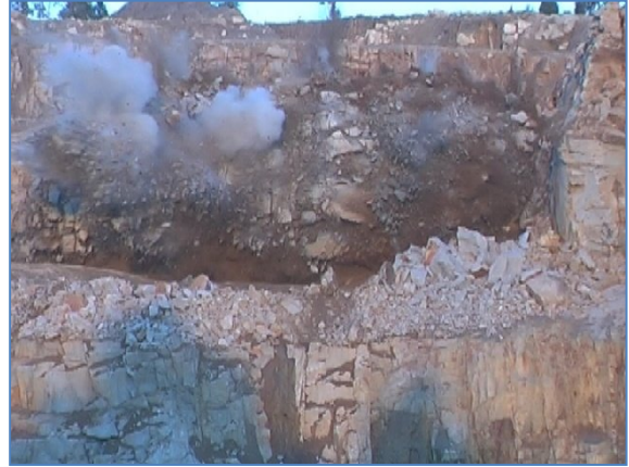
Figura 11 – Escape de gases das diaclases sub-verticais existentes no maciço.
