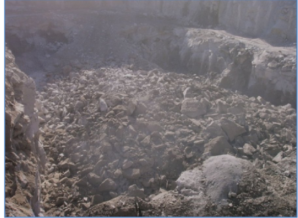
Figura 79 – Boa fragmentação zona A depois de inseridas as medidas de optimização. É visível a perfeita deslocação do material relativamente à nova frente livre.
