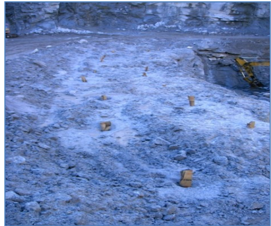
Figura 52 - Perfuração desalinhada e com plataforma irregular.
