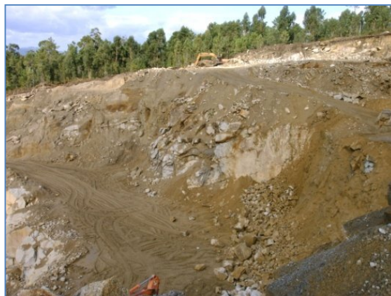
Figura 45 – Vista geral da zona B em flanco de encosta na 1ª Fase - Diagnóstico.
