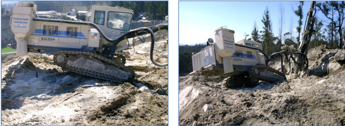
Figura 37 – Instabilidade do equipamento de perfuração nas bancadas irregulares.
