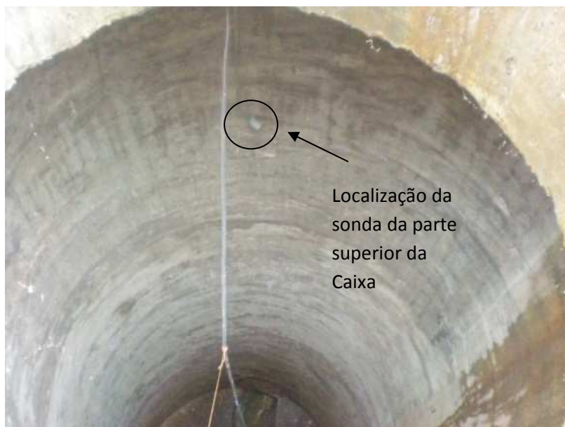
Imagem I.16 – Localização da sonda na parte superior da caixa de visita.
