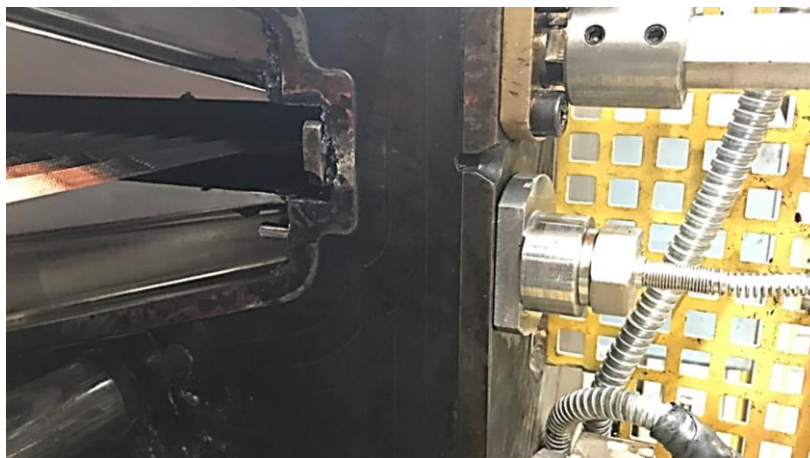
Figura 140 - Nova sonda RTD PT100 instalada no cabeçote, em substituição do purgador.
