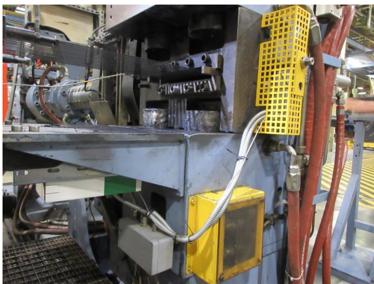
Figura 91 - Montagem final do sistema de monitorização de temperatura.
