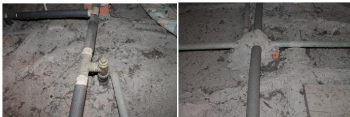
Figura 4.49 - Isolamento das tubagens de distribuição de água quente.
