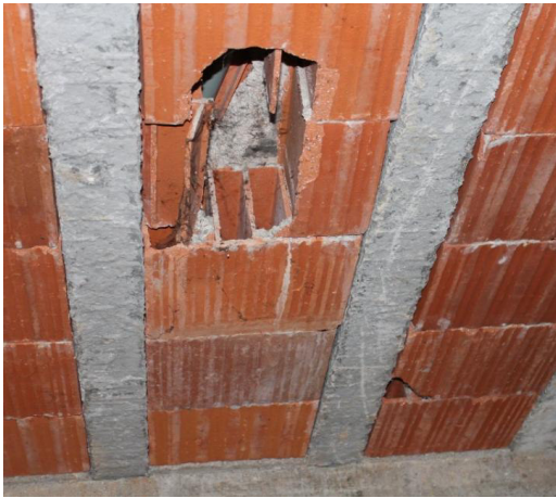
Figura 4.25 - Laje de vigotas e abobadilhas - vista inferior através da garagem (demonstração do nº de fiadas de furos).
