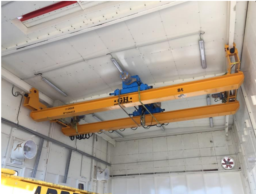
Figura 31 - Ponte Rolante Suspensa [36]
