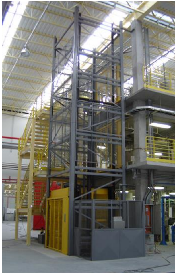
Figura 46 - Elevador de Carga [48]
