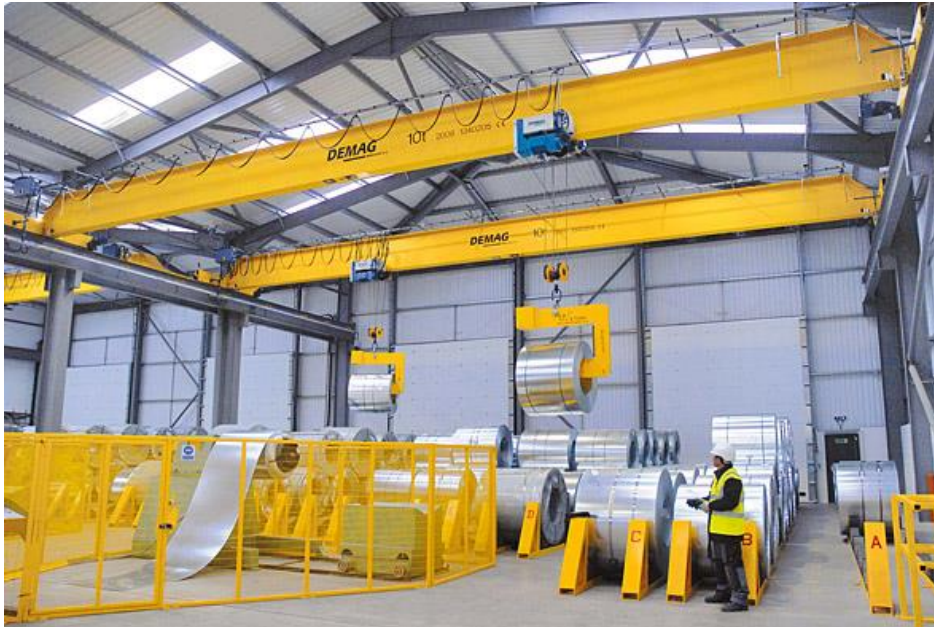
Figura 29 - Ponte Rolante Monoviga [35]
