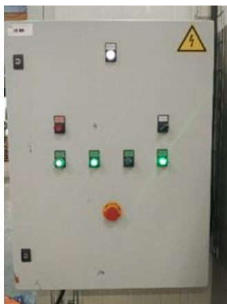
Figura 47 Quadro elétrico da cabine de pintura
