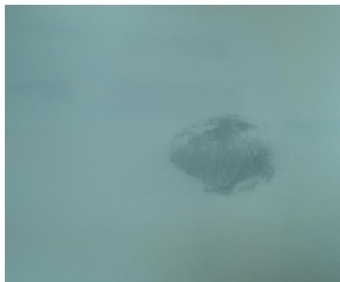
Figura 85 Manchas nas cores metálicas
