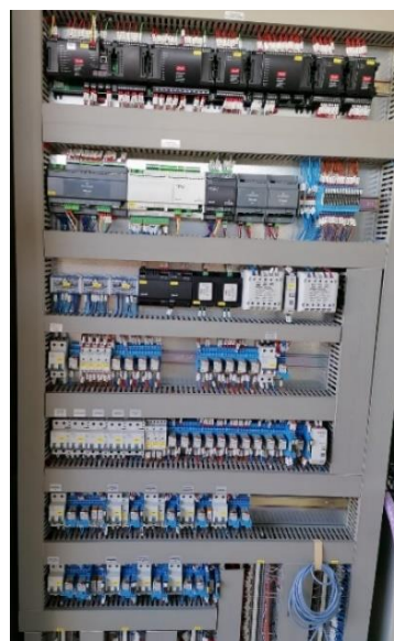
Figura 38 Quadro Elétrico Comando
