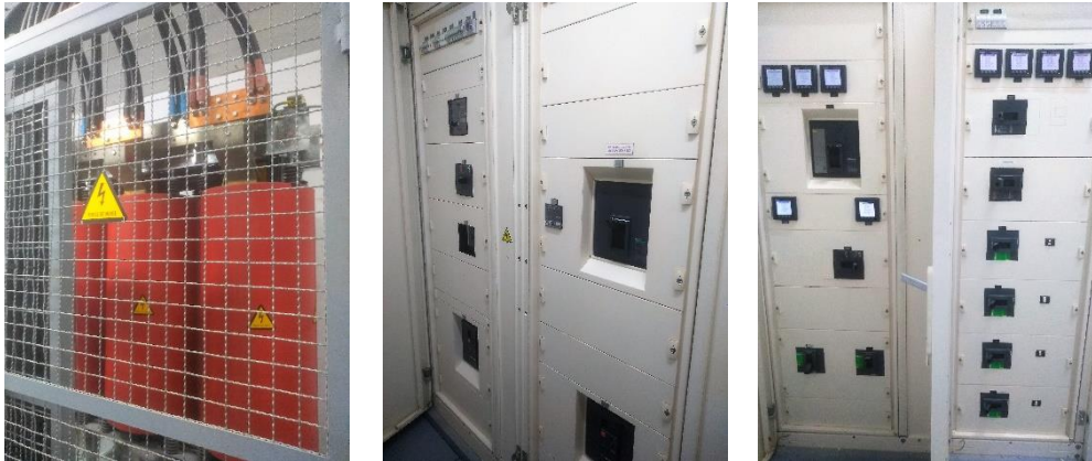
Figura 20 - Posto de transformação, QGBT Existente e QGBT Novo.
