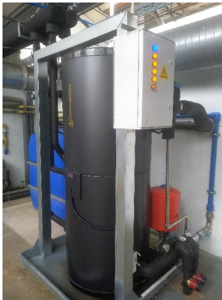
Figura 35 - Termoacumulador de capacidade 500 l.
