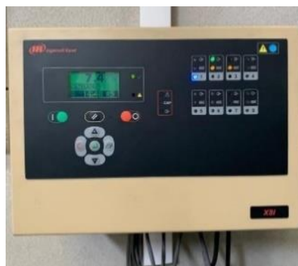
Figura 33 - Controlador centralizado presente na sala de compressores.
