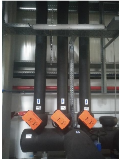
Figura 34 – Válvulas de controlo de chillers .
