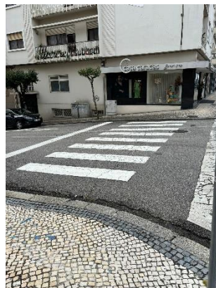
Figura 33- Degradação da estrada
