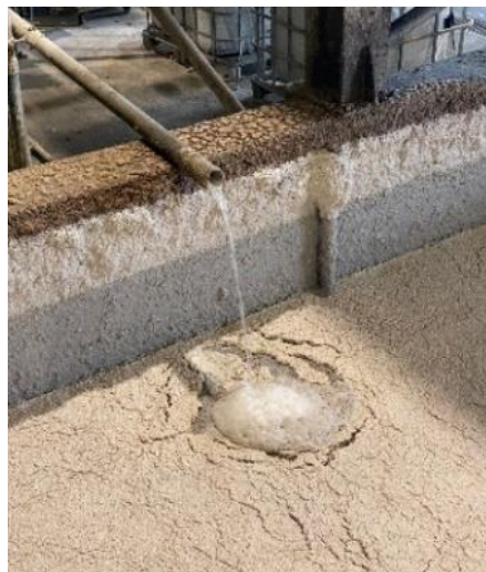
Figura 7.3. Passagem do efluente resultante da desidratação das lamas para o tanque SBR.
