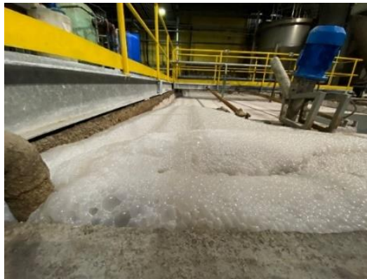
Figura 7.4. Purga do decantador lamelar para o tanque SBR.
