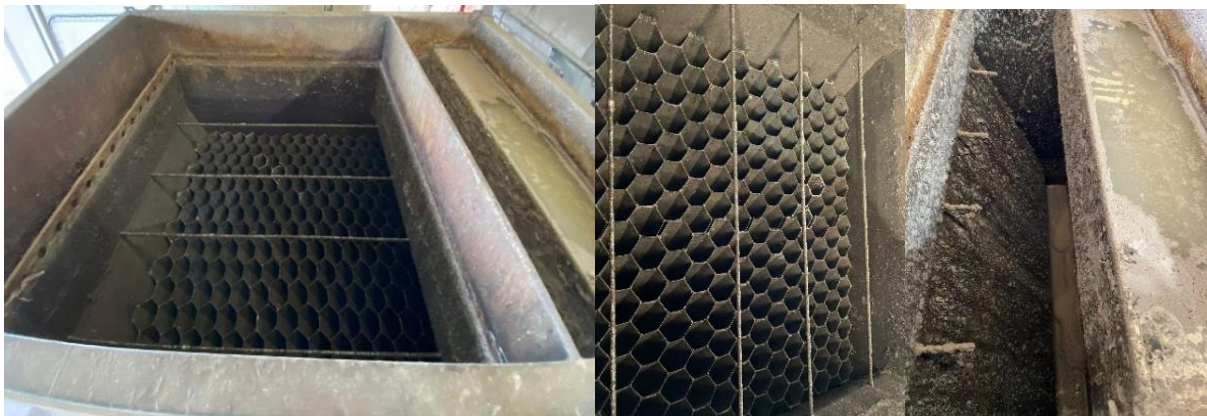
Figura 3.7. Estrutura do decantador lamelar, lamelas em pormenor e compartimento para o qual é encaminhado o efluente.
