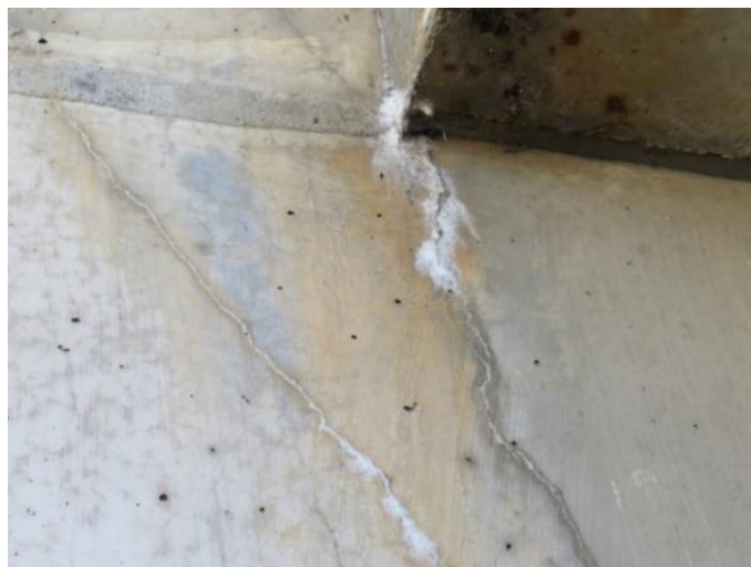
Figura 3.10 – Exemplo de eflorescência. (Acervo do autor)
