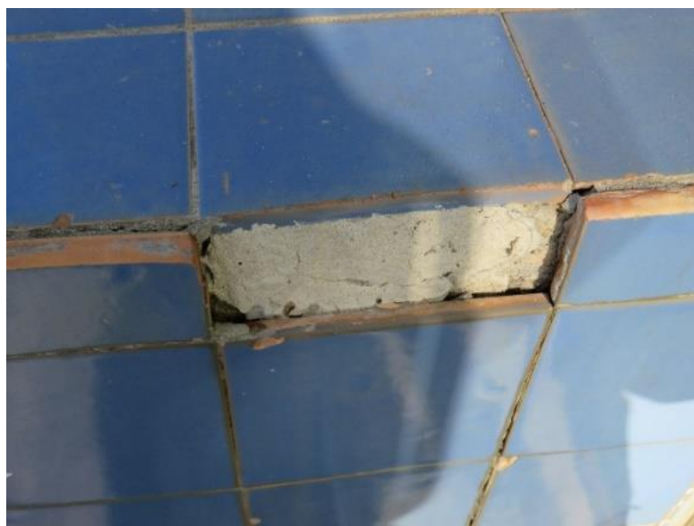
Figura 3.25 – Exemplo de destacamento do revestimento. (Acervo do autor)
