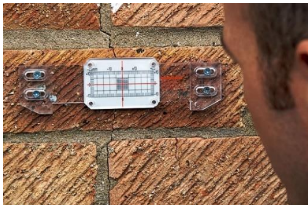
Figura 3.36 – Monitorização de fissuras com fissurômetro. (J. Roma Lda., 2019)
