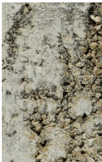
Figura 3.22 – Exemplo de segregação do betão. (Acervo do autor)
