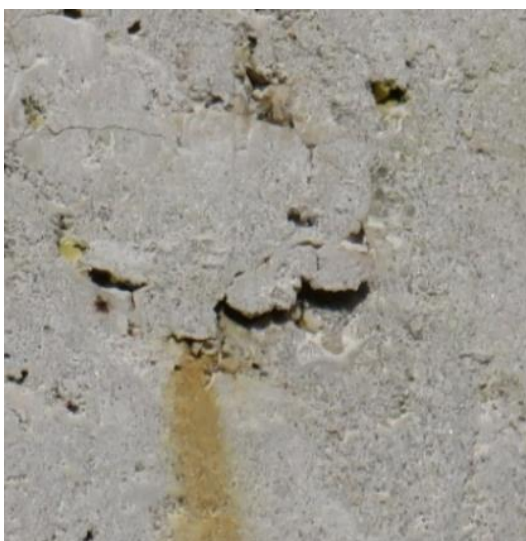
Figura 3.6 – Exemplo de delaminação do betão. (Acervo do autor)
