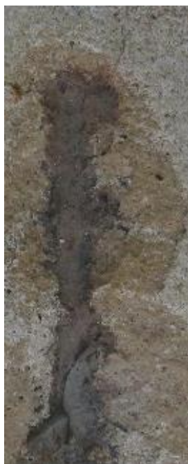
Figura 3.8 – Exemplo de armadura corroída. (Acervo do autor)
