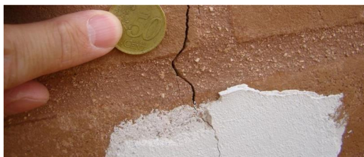
Figura 3.37 – Monitorização de fissuras com testemunho de gesso. (Silva e Torres, 2015)
