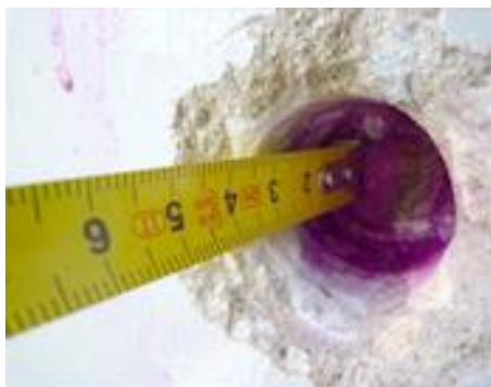
Figura 3.38 – Ensaio de determinação da profundidade de carbonatação do betão. (Spybuilding - Inspeção de Edifícios, 2018)
