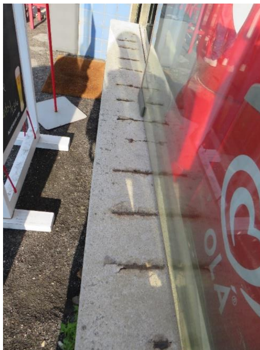
Figura 3.7 – Exemplo de armadura exposta. (Avervo do autor)
