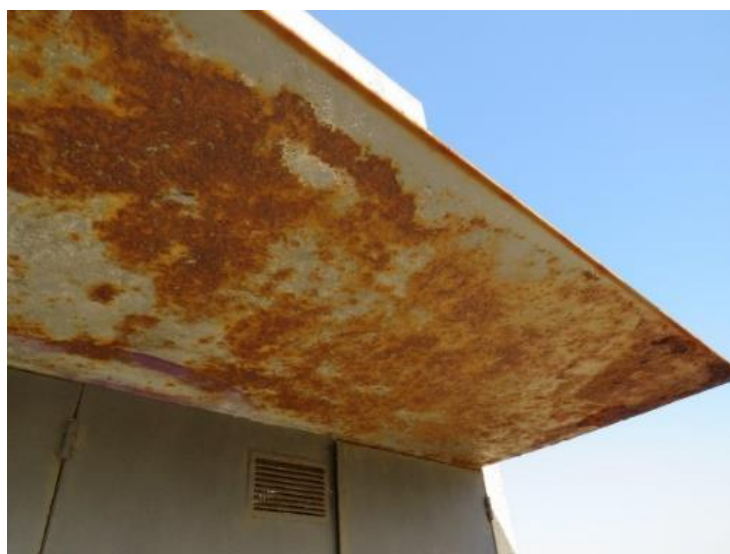
Figura 3.9 – Exemplo de corrosão de chapas e perfis metálicos. (Acervo do autor)
