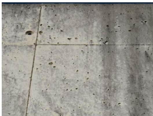
Figura 3.21 – Exemplo de desalinhamento do betão nas juntas das cofragens. (Acervo do autor)
