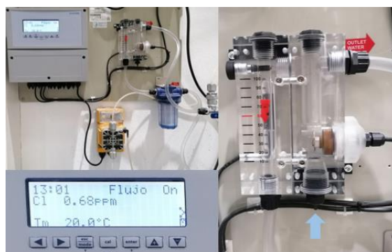
Figura 5.1- Controlo de Qualidade de água automático.
