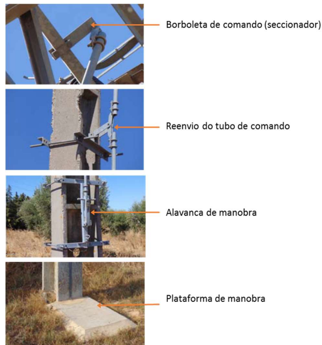
Figura 6: Comando manual do seccionador tripolar exterior (EDP Distribuição, 2015)
