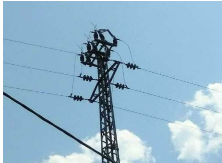
Figura 1: Seccionador Tripolar instalado na linha principal
