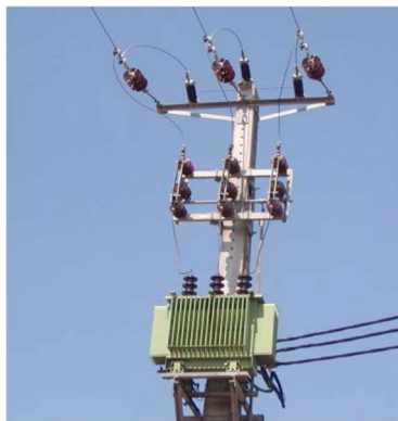
Figura 3: Isolamento de equipamentos a jusante - PT - (EDP Distribuição, 2015)
