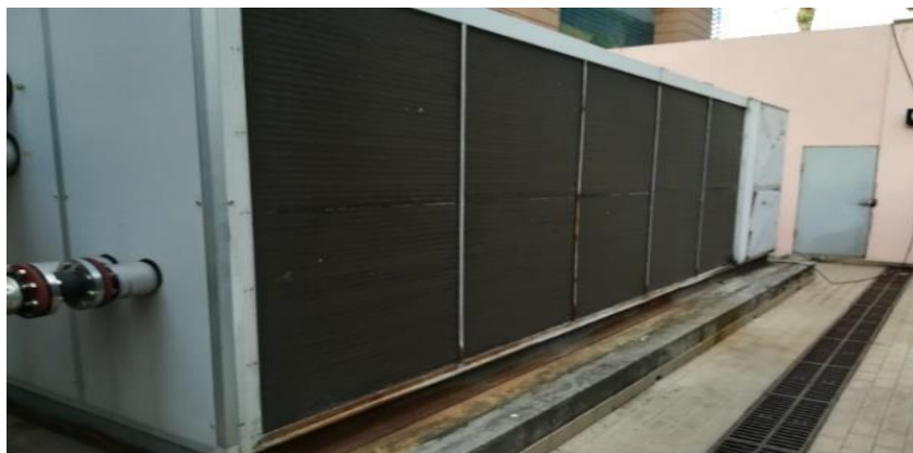
Figura 29 - Chiller, do tipo bomba de calor, com condensação a ar
