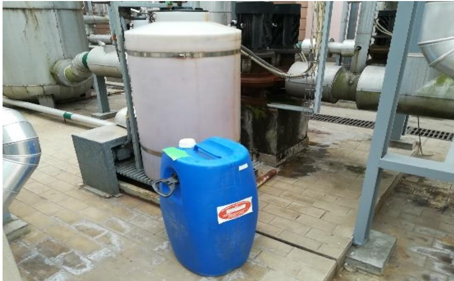
Figura 36 - Depósito de glicol
