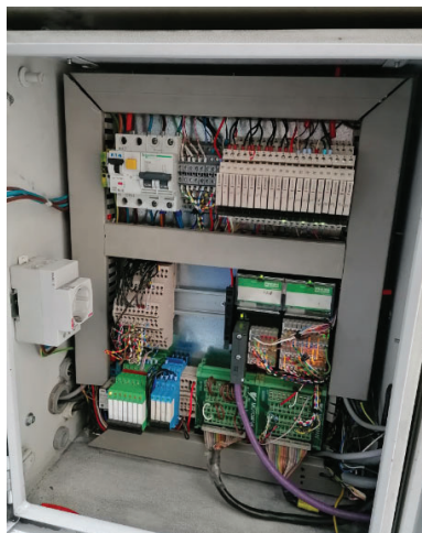
Figura 124 - Quadro Elétrico da célula
