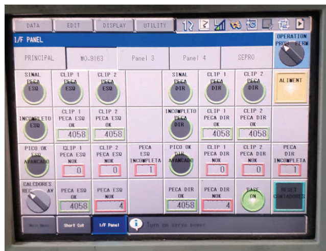
Figura 129 - Painel de controlo da base
